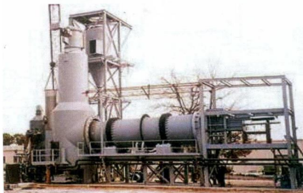
รูปที่ 2-18 ระบบเตาเผาแบบหมุนที่ติดตั้งใช้งานจริง
