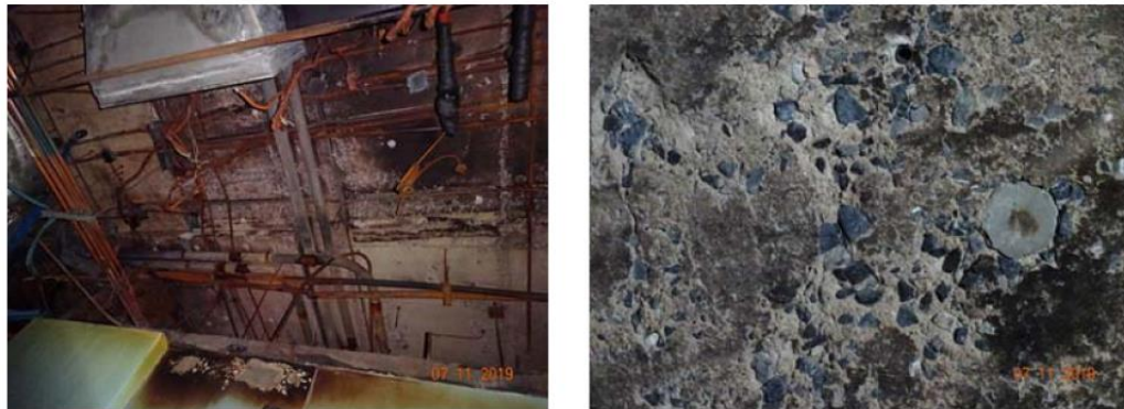
รูป 5.14 ความเสียหายด้านโครงสร้าง ท้องพื้นคอนกรีตหลุดร่อน
