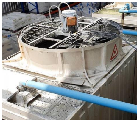
รูปที่ 4-17 แสดงใบพัดของ Cooling tower ไม่หมุน ถ่ายเมื่อ ; 8 ธันวาคม 2561
