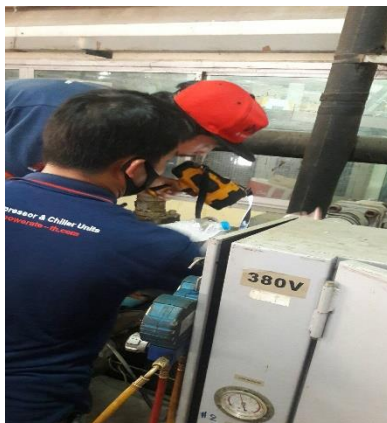
รูปที่ 4-22 แสดงการตรวจสอบการรั่วไหลของ Cooling agent ของระบบ Chiller ถ่ายเมื่อ ; 9 เมษายน 2562
