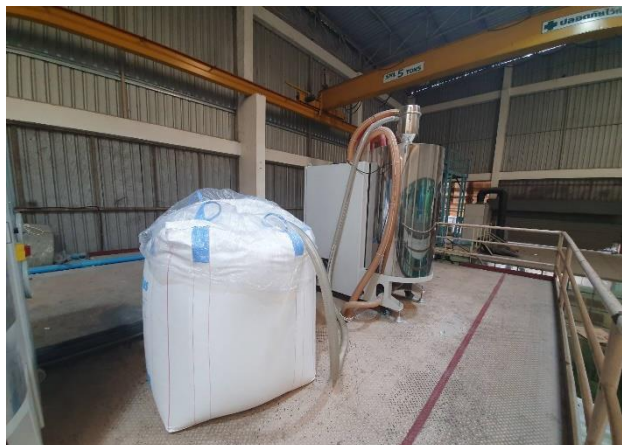
รูปที่ 2-6 เครื่องลดความชื้นเม็ด PET ถ่ายเมื่อ ; 30 พฤษภาคม 2563
