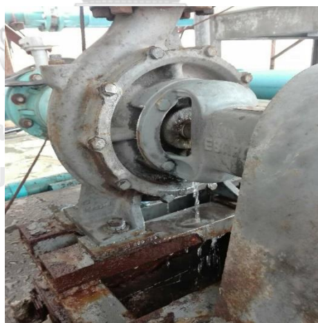
รูปที่ 4-18 แสดงน้ำรั่วบริเวณมอเตอร์ ถ่ายเมื่อ ; 8 กุมภาพันธ์ 2562
