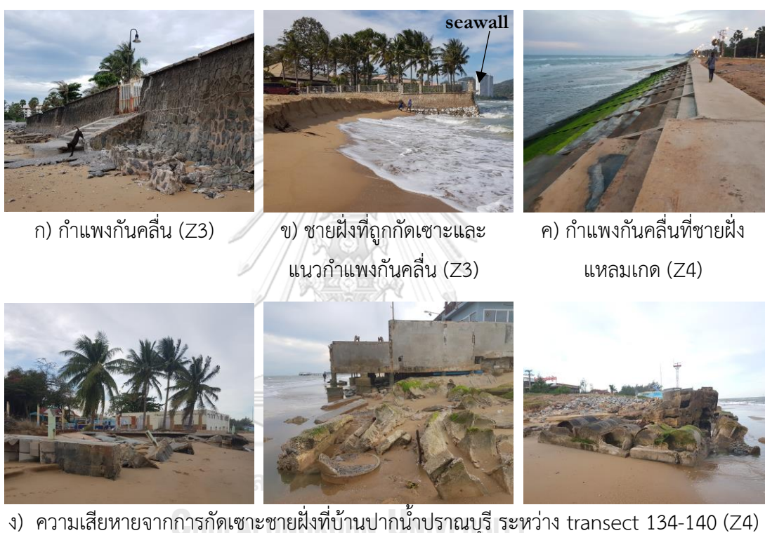
รูป 5.2 โครงสร้างและความเสียหายบริเวณชายฝั่ง Z3 และ Z4
