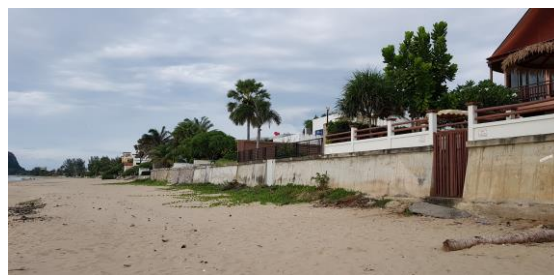
รูป ก.20 โครงสร้างรักษาเสถียรภาพชายฝั่ง บริเวณ transect 187 (7 มิ.ย 61)
