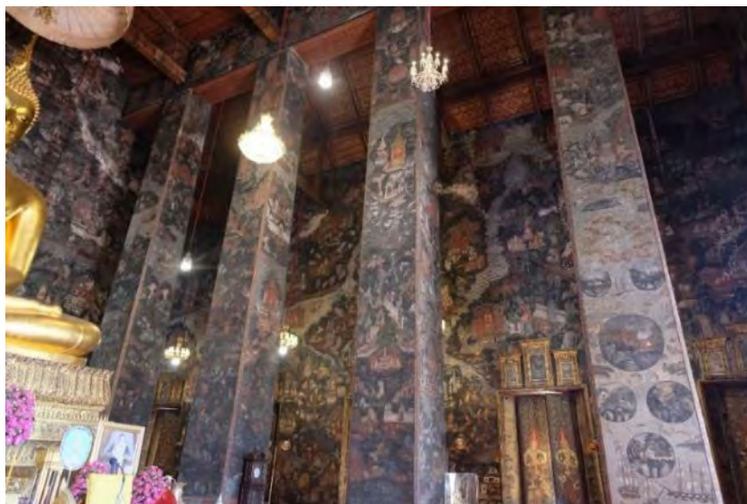
จากภาพที่ 122 แนวเสาร่วมในพระวิหารฝั่งตะวันตก พระวิหารวัดสุทัศน์ฯ
