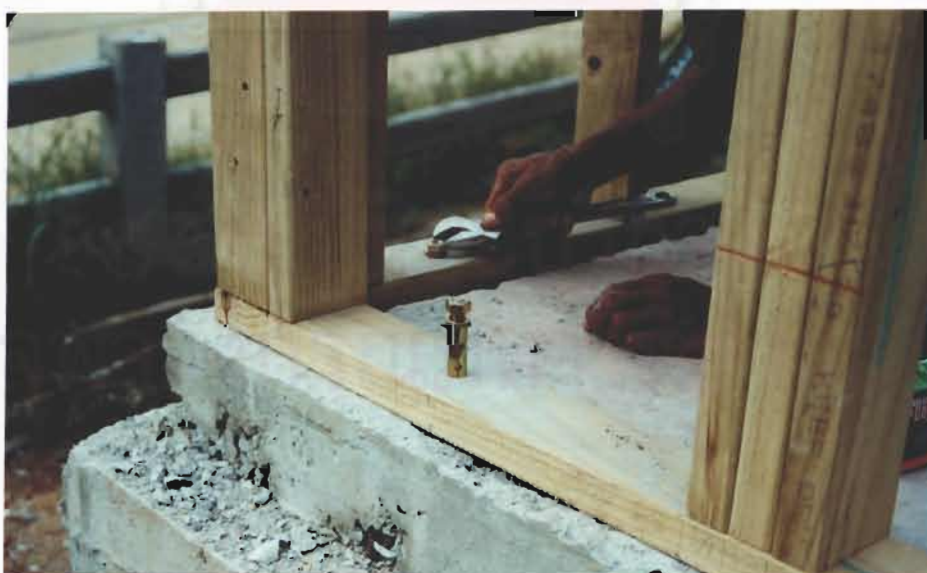
รูปที่ 4-28 การยึดโครงผนังไม้กับพื้นคอนกรีต
