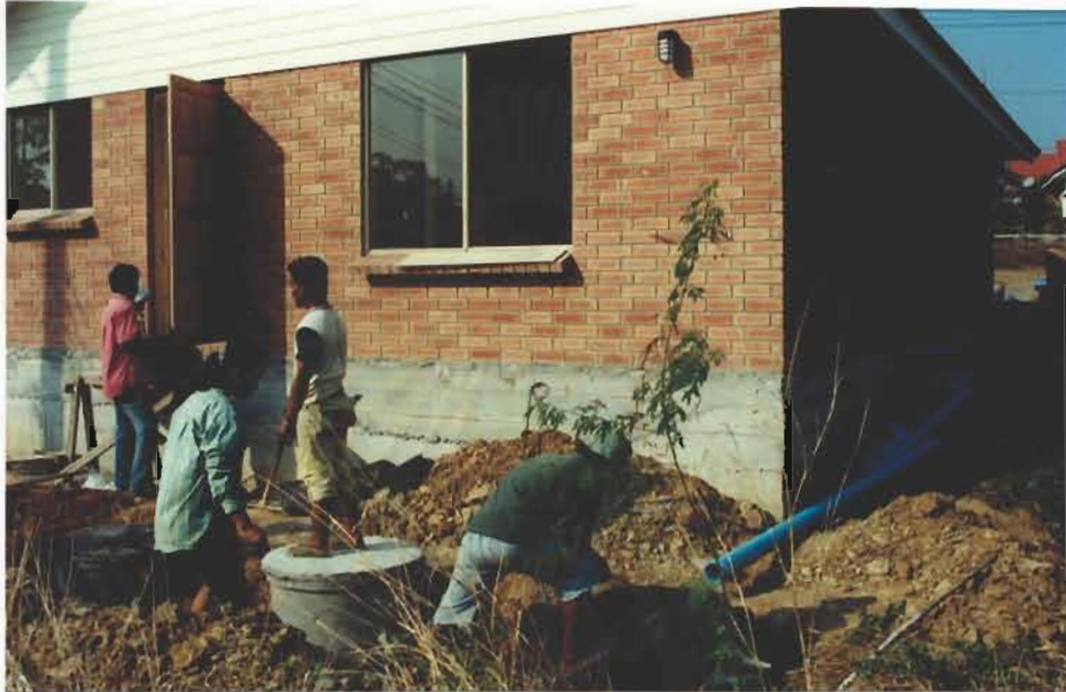
รูปที่ 4-54 ท่อสุขาภิบาลภายนอกอาคารสู่ถังบำบัด
