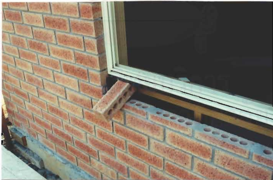
รูปที่ 4-49 รายละเอียดการก่ออิฐได้วงกบหน้าต่างโดยจะสอดอิฐเข้าไปได้วงกบติดกับแผ่นยาง (Flashing) เพื่อป้องกันน้ำฝนซึมเข้าสู่ภายในอาคาร
