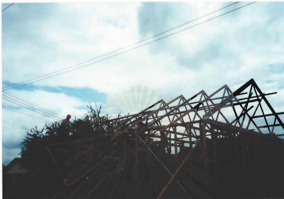
รูปที่ 4-31 การติดตั้งค้ำยันชั่วคราวระหว่างโครงหลังคาแต่ละโครง
