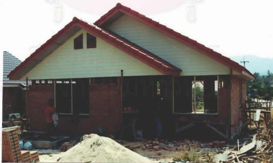
รูปที่ 4-46 การตั้งแนวอ้างอิงระดับที่มุมอาคารโดยรอบ
