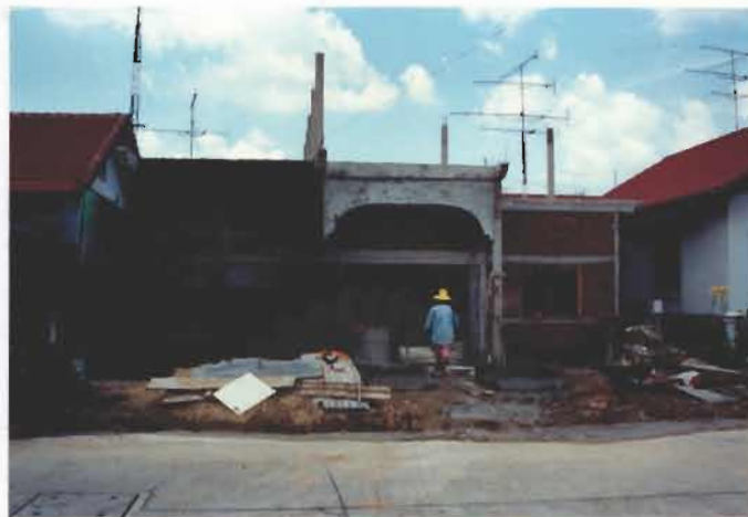
รูปที่ 4-62 ผนังก่ออิฐฉาบปูนเรียบ งานผนังอาคารเป็นผนังก่ออิฐครึ่งแผ่นฉาบปูนเรียบทั้งสองด้าน(ความหนาผนัง 10 เซนติเมตร)
