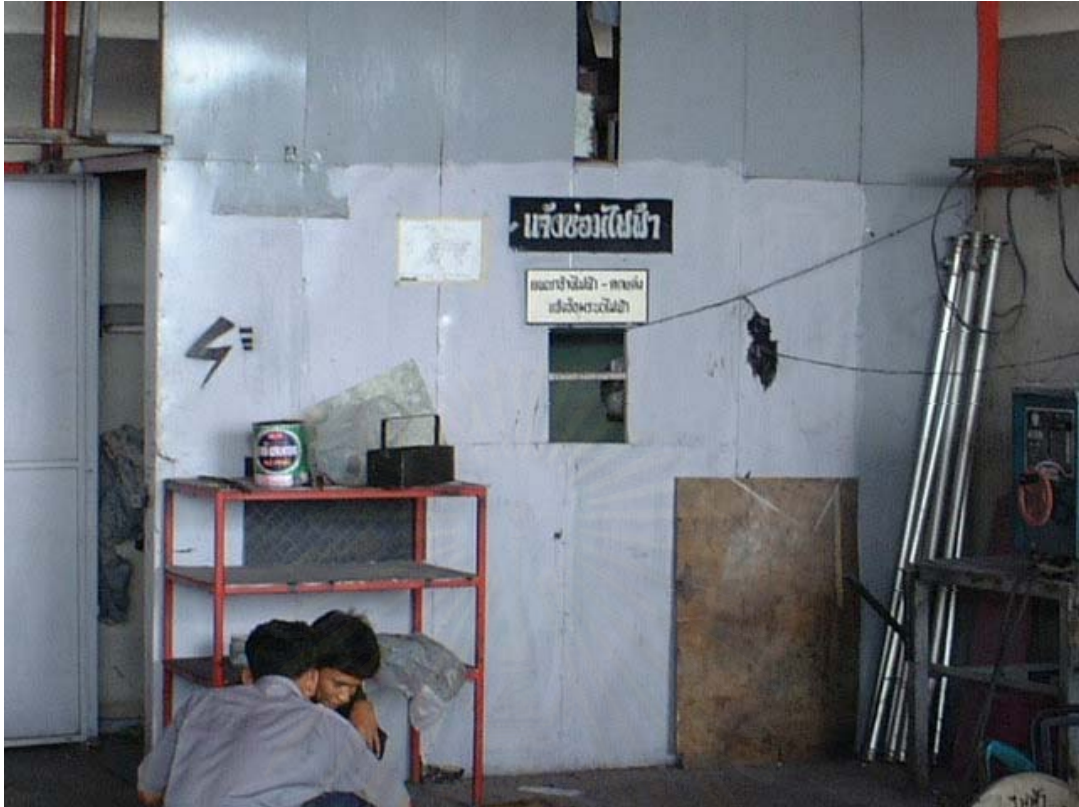
รูปที่ 3.8 รูปแสดง ตู้ซ่อมไฟฟ้า
