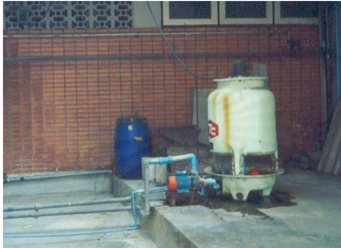
รูป 5.8 Cooling Tower
