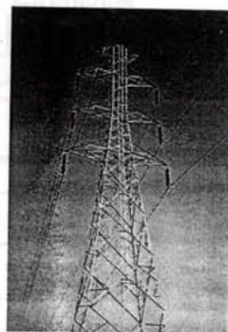
รูปที่ 3.24 สายส่ง 230 kV สายเดี่ยว วงจรคู่ (MM2-CR)
