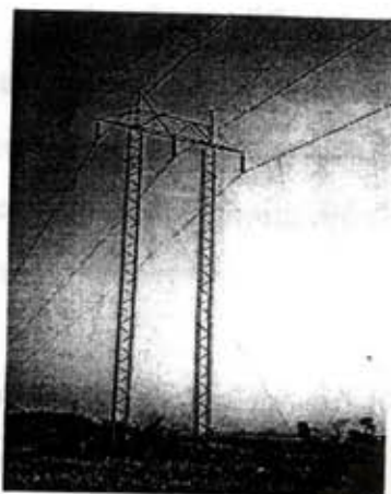
รูปที่ 3.25 สายส่ง 115 kV สายเดี่ยว วงจรเดี่ยว (LP1-TE)
