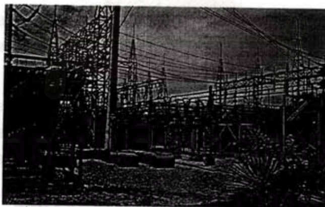
รูปที่ 3.15 สถานีสวิตช์ 69 kV ของสถานีไฟฟ้าย่อยบางกะปิ
