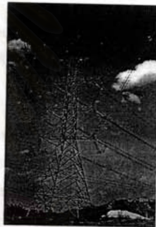
รูปที่ 3.22 สายส่ง 500 kV สายควบ วงจรคู่ (MM3-TTK)
