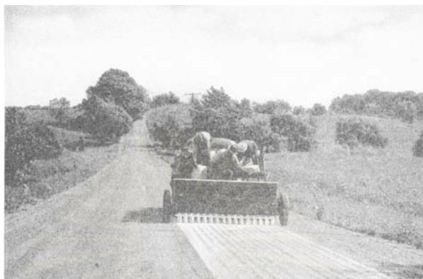
รูปที่ 2.8 แสดงการลาดแคลเซียมคลอไรด์ ลงบนถนนที่ไม่ได้ปูผิวทาง (Bruge, 1950)
