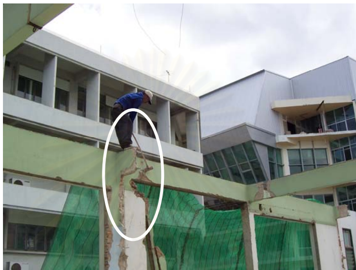
รูปที่ 3.24 การสกัดคานคอนกรีตเสริมเหล็กที่ตัดเหล็กที่ปลายด้านหนึ่ง
