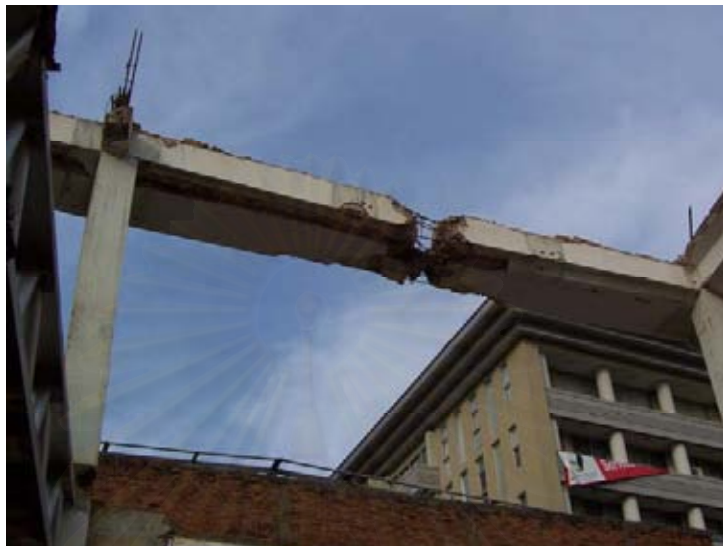
รูปที่ 3.27 คานคอนกรีตเสริมเหล็กที่ถูกสกัดตรงกลางคาน
