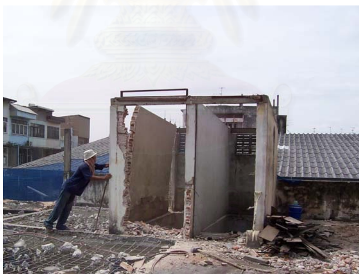
รูปที่ 3.32 การล้มผนังหลังจากสกัดผนังด้านข้าง
