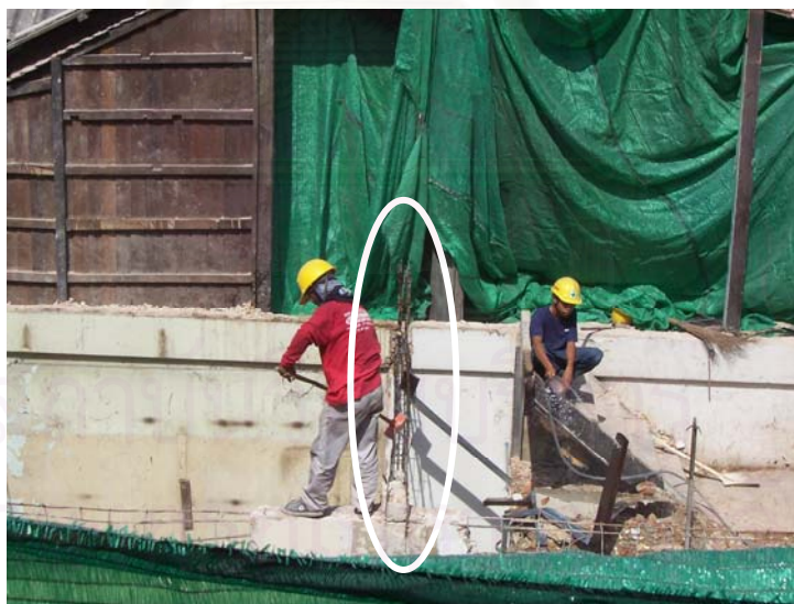
รูปที่ 3.7 เสาคอนกรีตเสริมเหล็กที่ถูกสกัดคอนกรีตออกหมดเหลือแต่เหล็กเสริม
