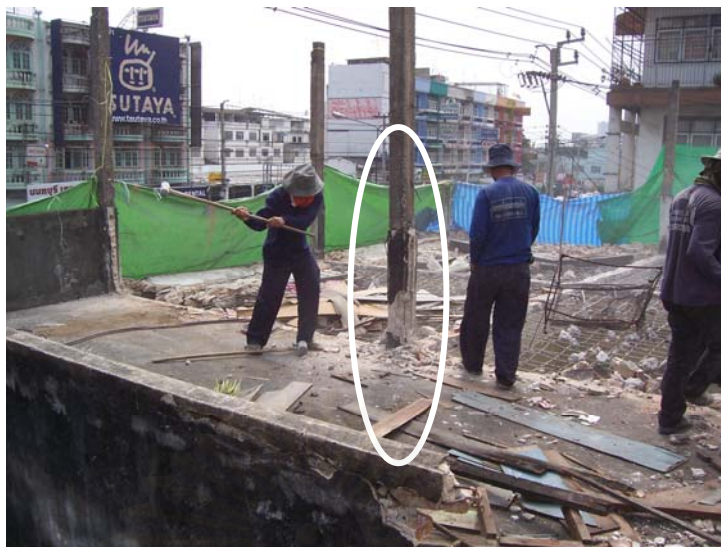
รูปที่ 3.6 การรื้อถอนเสาคอนกรีตเสริมเหล็กด้วยวิธีการสกัดคอนกรีตที่โคนเสา
