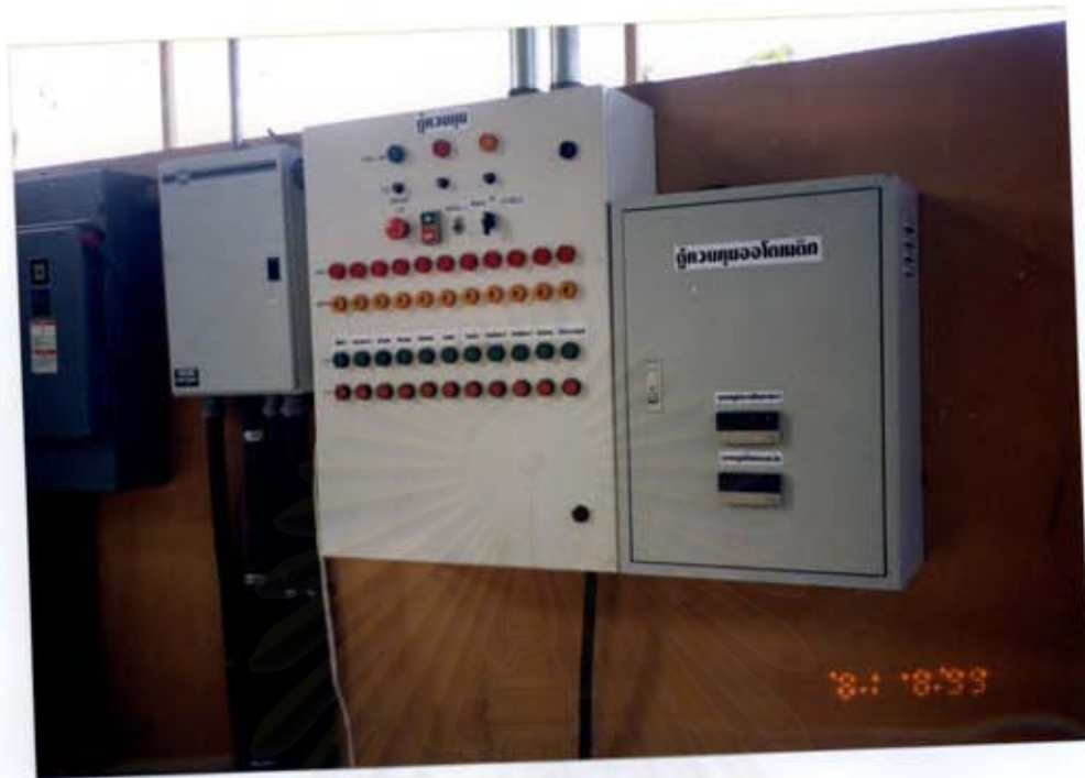
รูปที่ 14 ระบบควบคุมอุณหภูมิ
