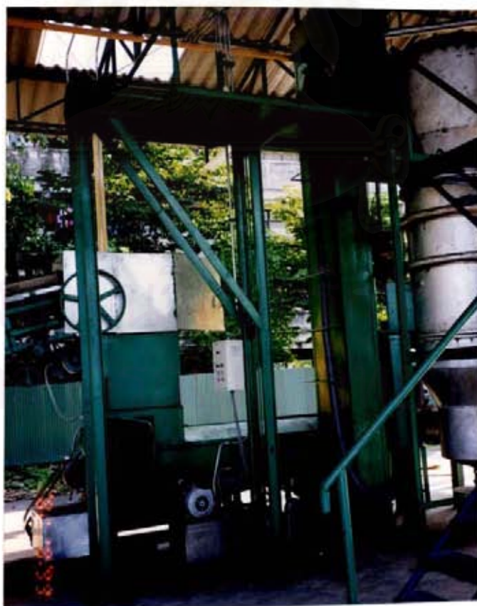
รูปที่ 13 ระบบควบคุมการป้อนอัตโนมัติ
