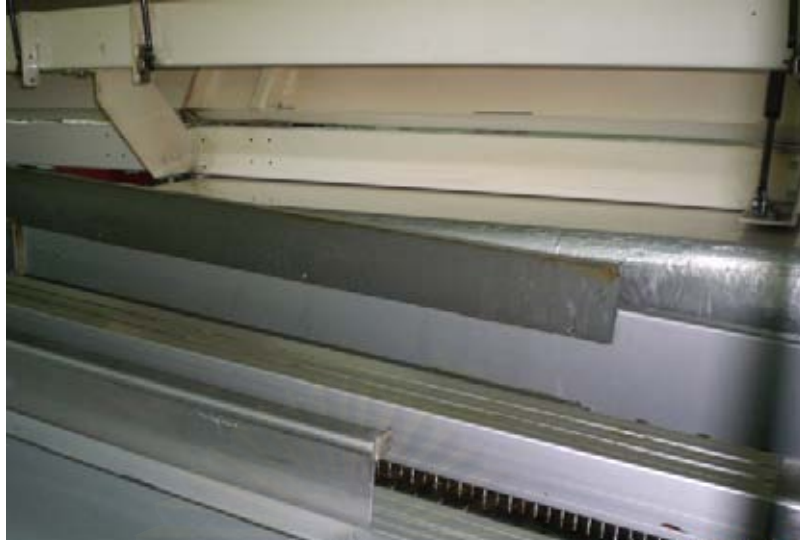
รูปที่ ค-26 Main Conveyor อยู่ภายในเครื่องจักร
