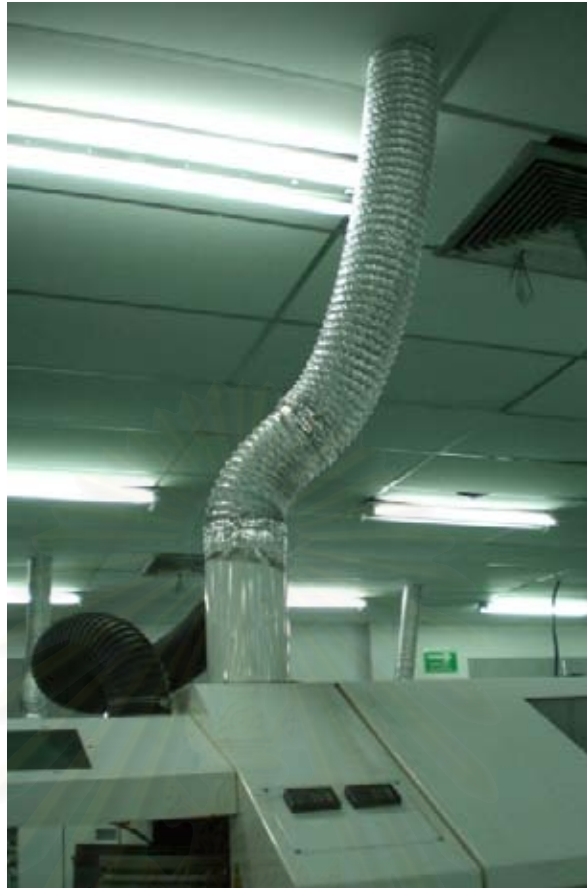
รูปที่ ค-32 Exhaust Blowers
