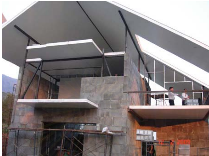
ภาพที่ 3.2 บ้านผู้โถกที่รื้อที่กำลังอยู่ในขั้นตอนการก่อสร้าง
