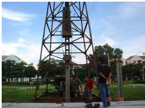
รูปที่ 4-37 แสดงใช้ปั้นจั่นตอกเข็มตามตำแหน่ง
