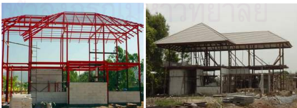
เชื่อมรอยต่อต่างๆและทาสีรองพื้นกันสนิมทั้งหมดก่อนลงมือปูวัสดุคุมหลังคา
