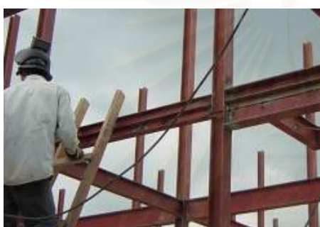
เชื่อมเหล็กฉากขนาดเล็กที่คานสำหรับยึดกับเหล็กเสริมคอนกรีตของพื้นหล่อในที่
