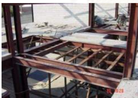
เตรียมแบบพื้นและค้ำยันเพื่อเพื่อเทคอนกรีตพื้นหล่อในที่
