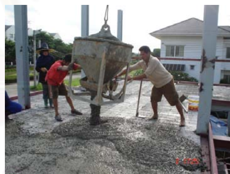
รูปที่ 4-63 เทคอนกรีตทับหน้าความหนา 5 ซม.
