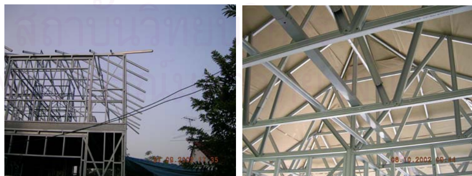
รูปที่ 4-127 หลังคา ระบบโครงถัก (Truss) กิ่งสำเร็จรูปคำนวณและตัดแต่งขึ้นส่วนจากโรงงาน
