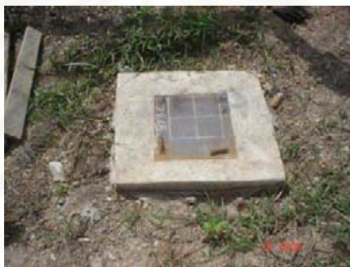
รูปที่ 4-53 แสดงการวางตำแหน่งของเสาบนแผ่นประทับเหล็ก
