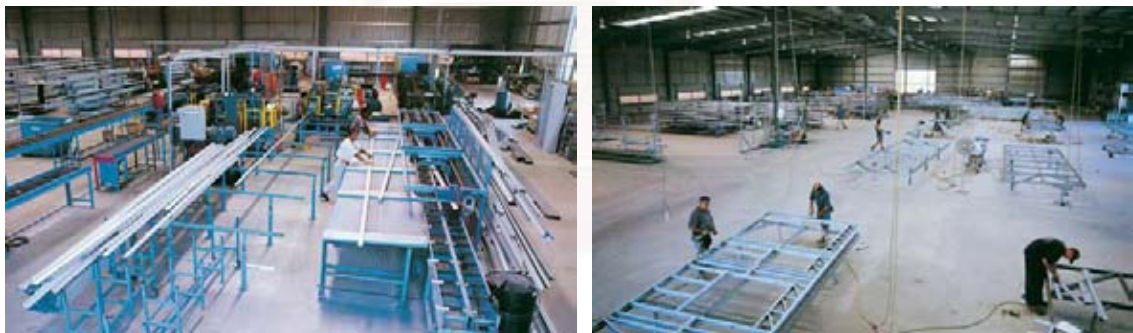
รูปที่ 5-4 การตัดแต่ง และประกอบชิ้นส่วนในโรงงานตามรายการ การถอดแบบจากคอมพิวเตอร์
