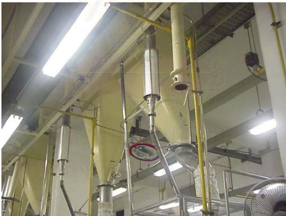
รูปที่ 1.7 ไซโคลนที่ติดตั้งและใช้งานอยู่แล้วจริงบริเวณเครื่องบรรจุ ซึ่งเป็น Model อื่น ที่ไม่ใช่ Lapple's model
