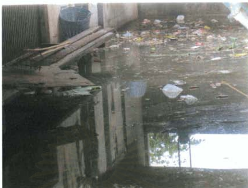
ภาพที่ 6.10 น้ำเน่าเสียที่บริเวณประตูระบายน้ำคลองศาลเจ้า ในพื้นที่หน้าวงน้ำฝั่งตะวันตกของกรุงเทพมหานคร
