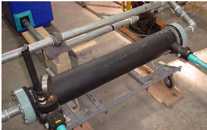
รูปที่ 4.11 อุปกรณ์ระบายความร้อน
