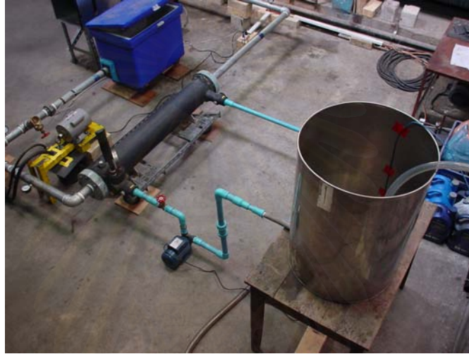
รูปที่ 4.33 ชุดระบายความร้อน
