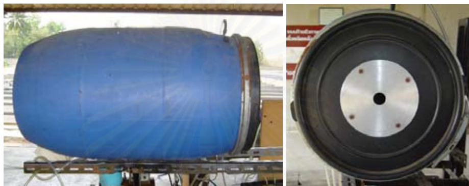
รูปที่ 4-13 แสดงถังพักอากาศและการติดตั้ง Orifice Plate
