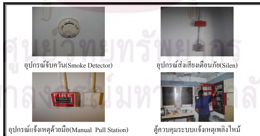
ภาพที่ 7.3.6 ระบบสัญญาณแจ้งเหตุเพลิงไหม้
