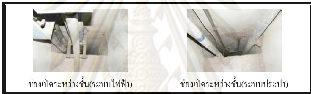
ภาพที่ 4.3.3 ระบบระบายควันและควบคุมการแพร่กระจายควัน
