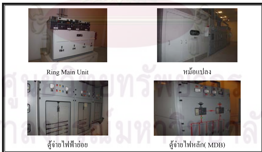
ภาพที่ 7.1.2 ระบบไฟฟ้า
