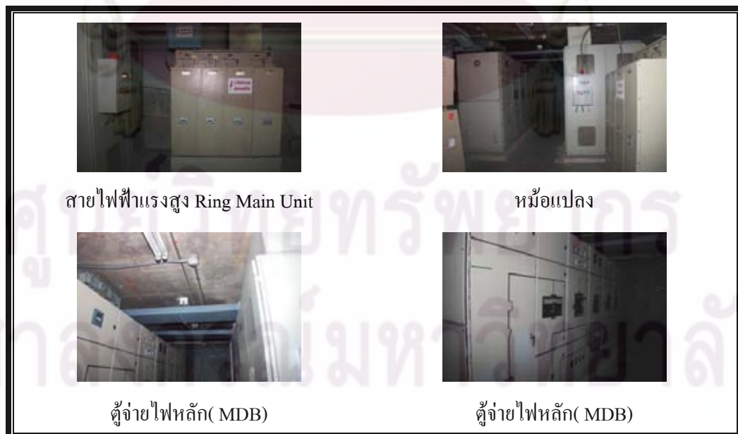
ภาพที่ 4.1.2 ระบบไฟฟ้า
