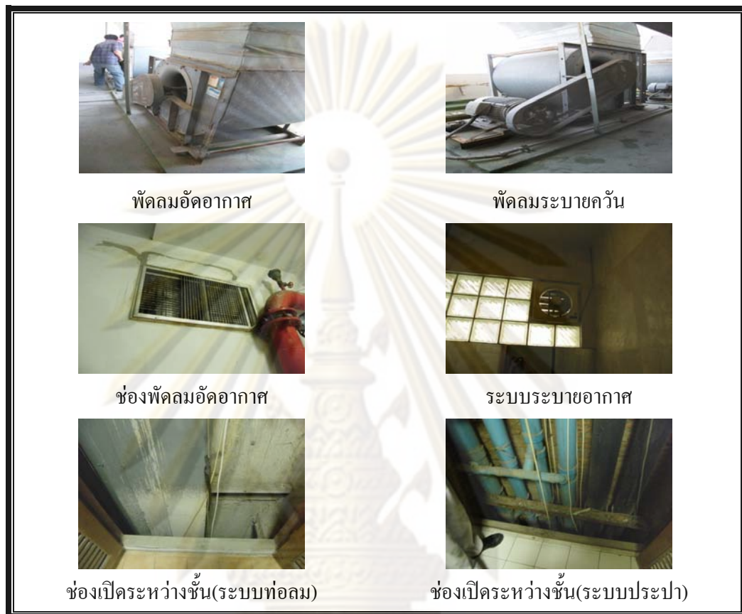
ภาพที่ 8.3.3 ระบบระบายควันและควบคุมการแพร่กระจายควัน
