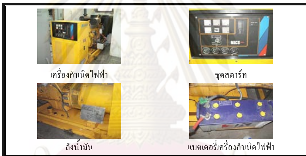
ภาพที่ 3.3.4 ระบบไฟฟ้าสำรองฉุกเฉิน
