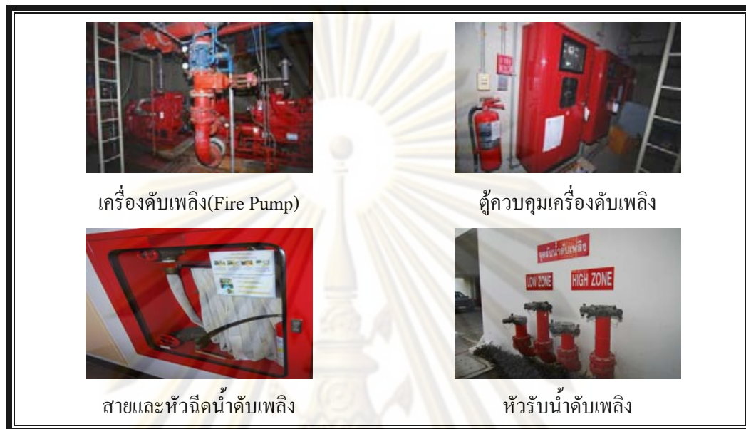
ภาพที่ 1.3.8 ระบบการจ่ายน้ำดับเพลิง เครื่องสูบน้ำดับเพลิงและหัวฉีดน้ำดับเพลิง
