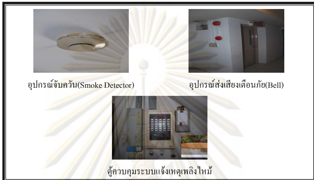
ภาพที่ 4.3.6 ระบบสัญญาณแจ้งเหตุเพลิงไหม้
