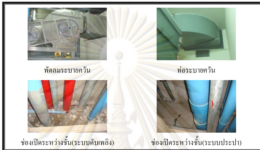
ภาพที่ 5.3.3 ระบบระบายควันและควบคุมการแพร่กระจายควัน
