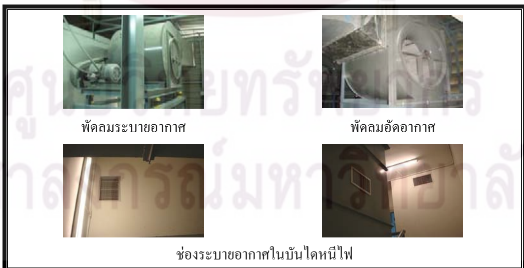
ภาพที่ 5.2.5 ระบบระบายอากาศ
