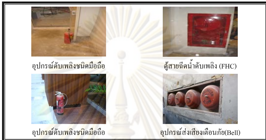
ภาพที่ 5.3.7 ระบบการติดตั้งอุปกรณ์ดับเพลิง
