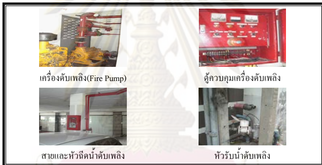
ภาพที่ 3.3.7 ระบบการจ่ายน้ำดับเพลิง เครื่องสูบน้ำดับเพลิงและหัวฉีดน้ำดับเพลิง
