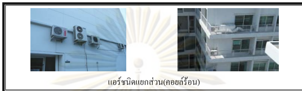
ภาพที่ 7.1.3 ระบบปรับอากาศ
