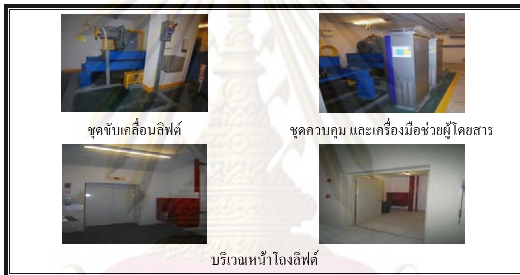
ภาพที่ 7.3.5 ระบบลิฟต์ดับเพลิง
