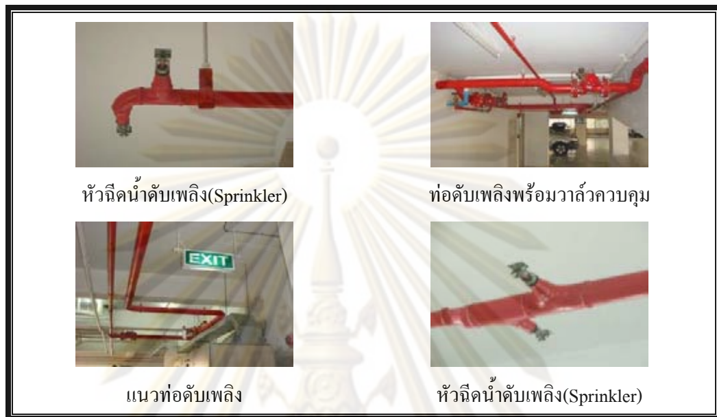
ภาพที่ 5.3.9 ระบบดับเพลิงอัตโนมัติ
