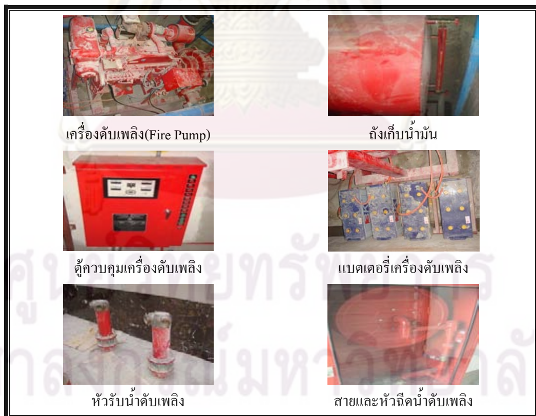
ภาพที่ 5.3.8 ระบบการจ่ายน้ำดับเพลิง เครื่องสูบน้ำดับเพลิงและหัวฉีดน้ำดับเพลิง
