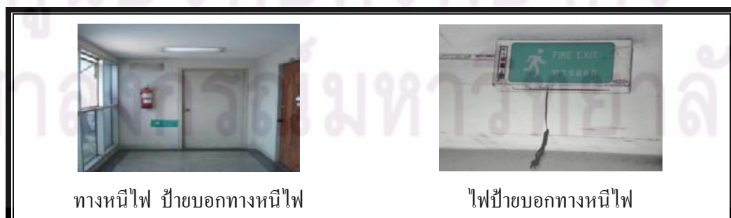
ภาพที่ 3.3.2 เครื่องหมายและไฟป้ายบอกทางออกฉุกเฉิน
