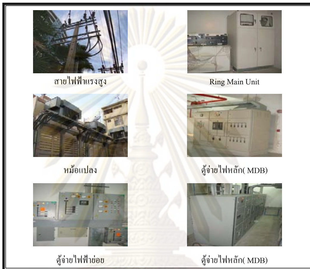
ภาพที่ 5.1.2 ระบบไฟฟ้า
