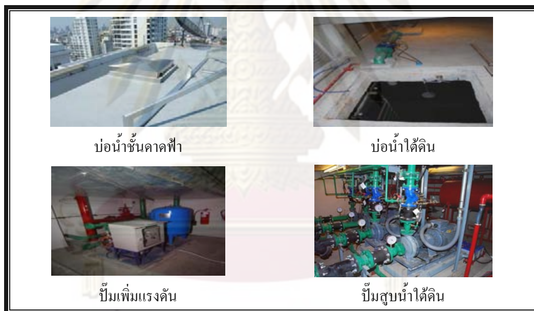
ภาพที่ 7.2.1 ระบบประปา
