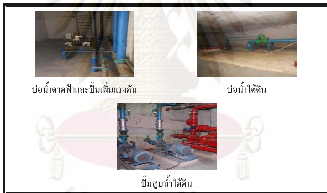
ภาพที่ 4.2.1 ระบบประปา
