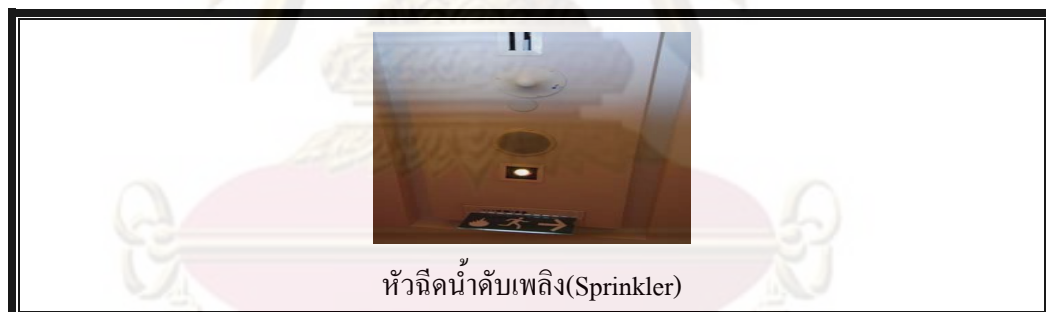
ภาพที่ 6.3.9 ระบบดับเพลิงอัตโนมัติ
