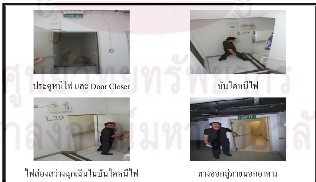
ภาพที่ 6.3.1 ระบบบันไดหนีไฟและทางหนีไฟ
