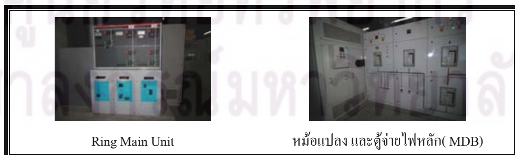
ภาพที่ 6.1.2 ระบบไฟฟ้า
