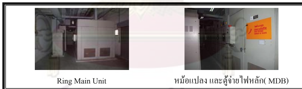
ภาพที่ 2.1.2 ระบบไฟฟ้า
