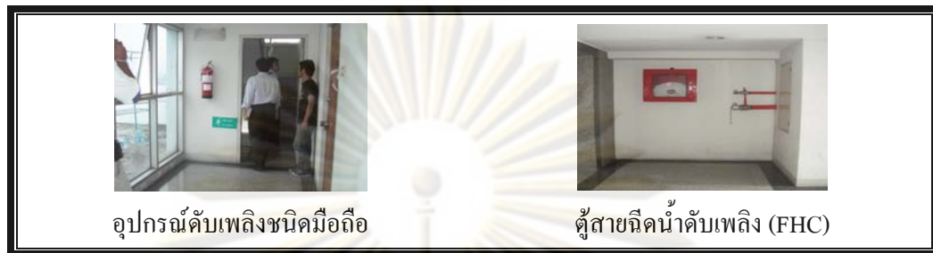
ภาพที่ 3.3.6 ระบบการติดตั้งอุปกรณ์ดับเพลิง
