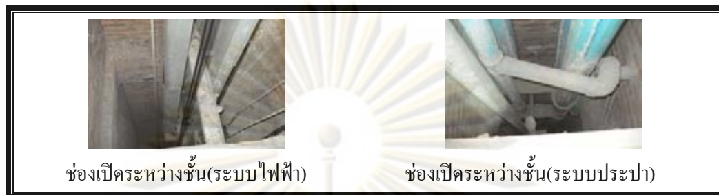
ภาพที่ 3.3.3 ระบบระบายควันและควบคุมการแพร่กระจายควัน
