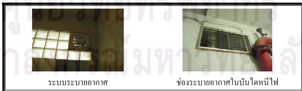
ภาพที่ 8.2.5 ระบบระบายอากาศ
