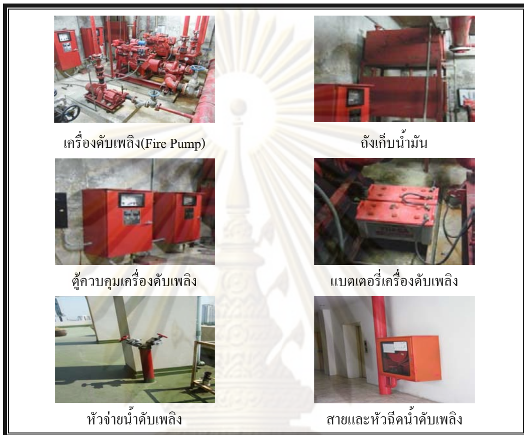
ภาพที่ 8.3.7 ระบบการจ่ายน้ำดับเพลิง เครื่องสูบน้ำดับเพลิงและหัวฉีดน้ำดับเพลิง
