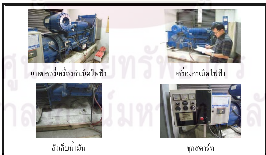
ภาพที่ 8.3.4 ระบบไฟฟ้าสำรองฉุกเฉิน
