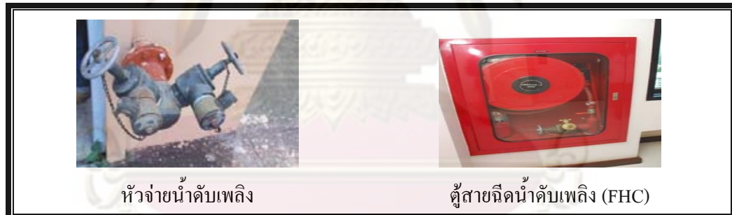
ภาพที่ 4.3.7 ระบบการติดตั้งอุปกรณ์ดับเพลิง
