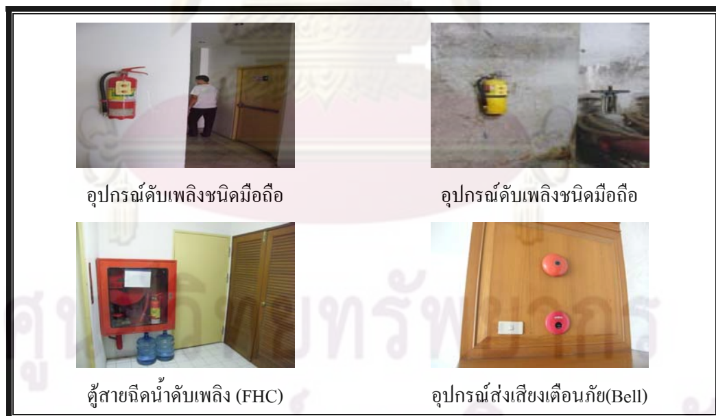
ภาพที่ 8.3.6 ระบบการติดตั้งอุปกรณ์ดับเพลิง
