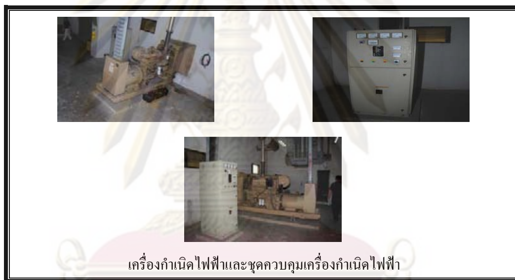
ภาพที่ 2.3.4 ระบบไฟฟ้าสำรองฉุกเฉิน
