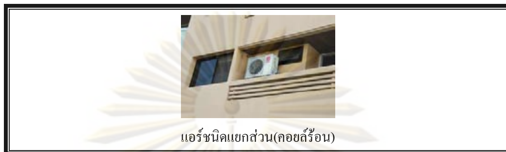
ภาพที่ 4.1.3 ระบบปรับอากาศ
