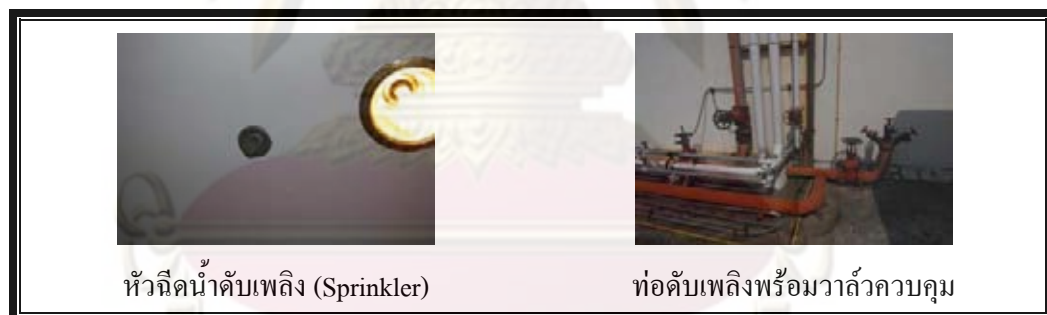
ภาพที่ 1.3.9 ระบบดับเพลิงอัตโนมัติ
