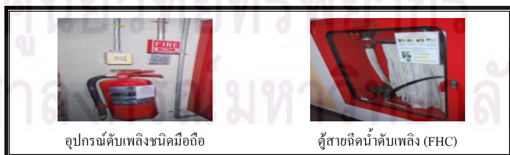
ภาพที่ 1.3.7 ระบบการติดตั้งอุปกรณ์ดับเพลิง
