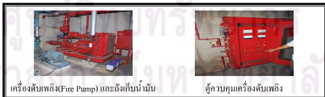
ภาพที่ 4.3.8 ระบบการจ่ายน้ำดับเพลิง เครื่องสูบน้ำดับเพลิงและหัวฉีดน้ำดับเพลิง
