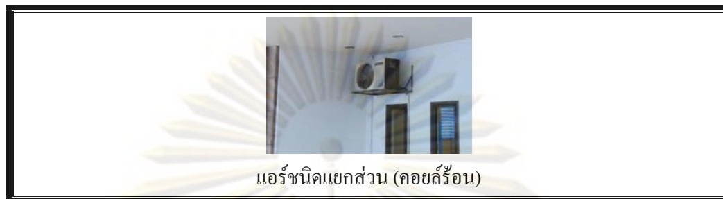
ภาพที่ 1.1.3 ระบบปรับอากาศ
