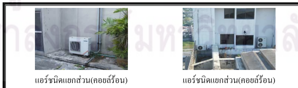
ภาพที่ 2.1.3 ระบบปรับอากาศ
