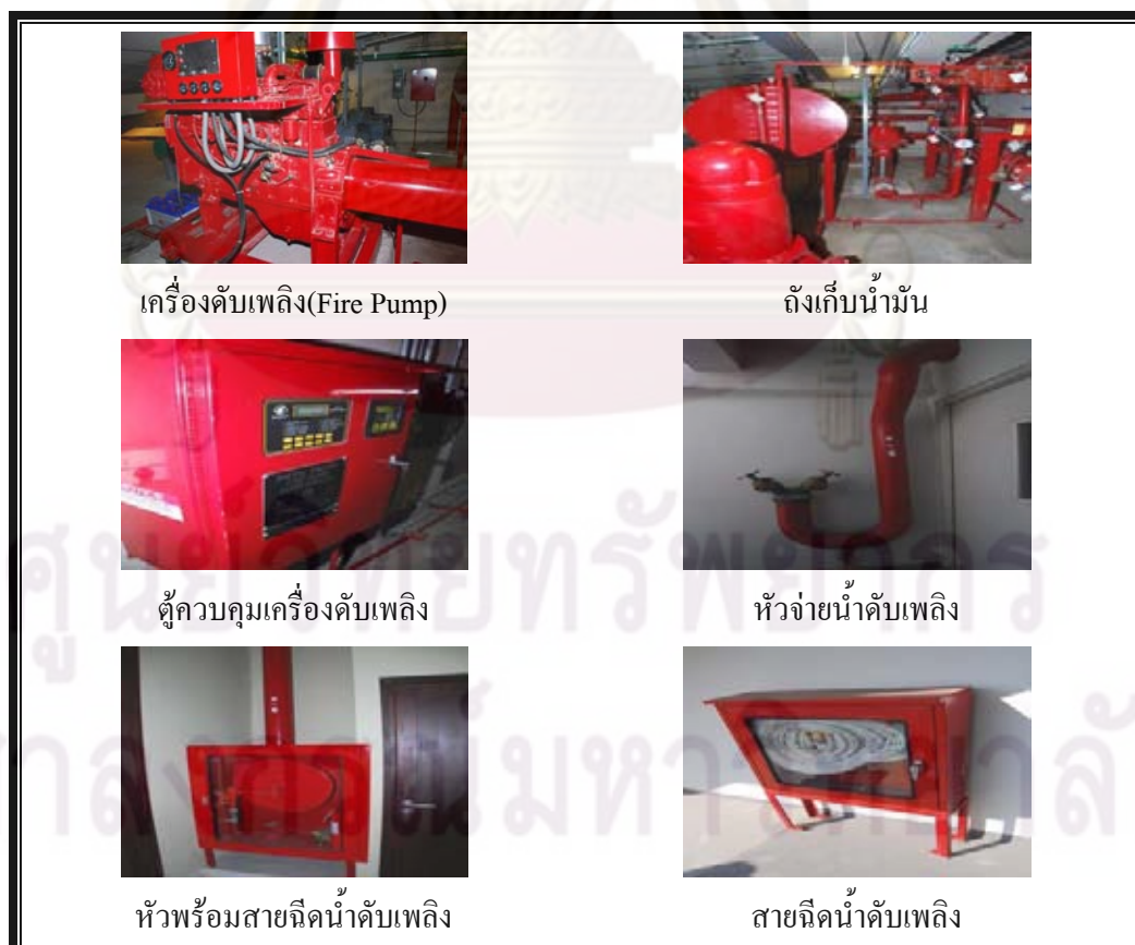
ภาพที่ 7.3.8 ระบบการจ่ายน้ำดับเพลิง เครื่องสูบน้ำดับเพลิงและหัวฉีดน้ำดับเพลิง
