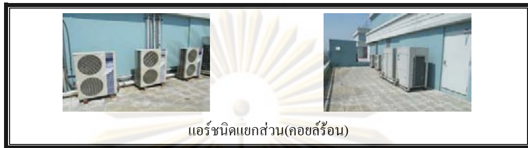
ภาพที่ 6.1.3 ระบบปรับอากาศ
