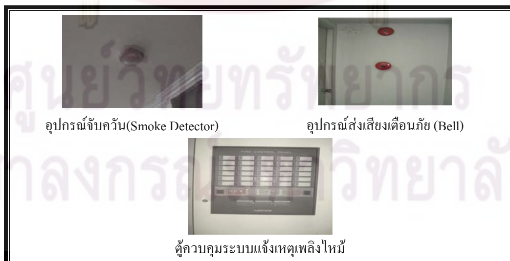
ภาพที่ 3.3.5 ระบบสัญญาณแจ้งเหตุเพลิงไหม้
