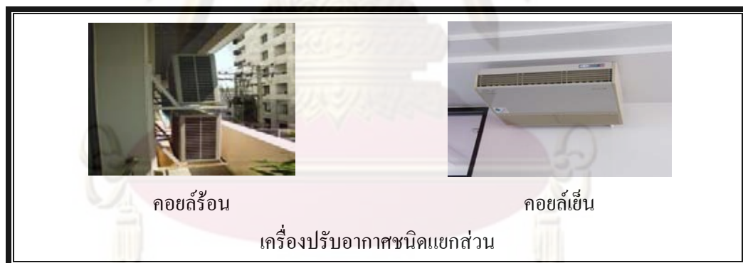
ภาพที่ 8.1.3 ระบบปรับอากาศ
