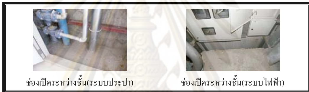
ภาพที่ 6.3.3 ระบบระบายควันและควบคุมการแพร่กระจายควัน
