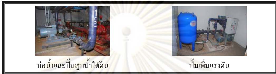
ภาพที่ 2.2.1 ระบบประปา
