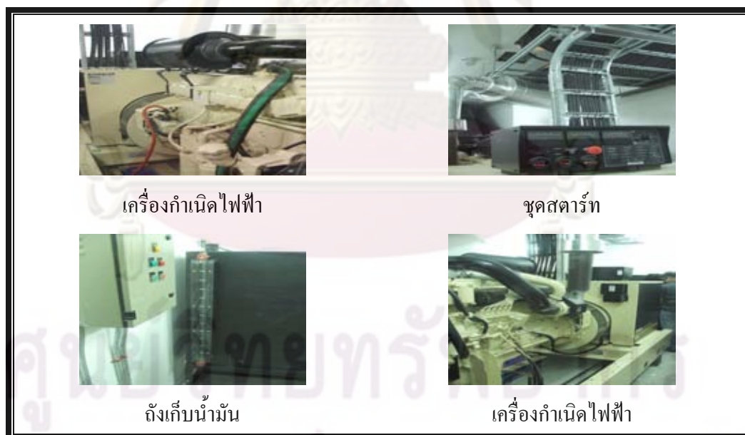
ภาพที่ 5.3.4 ระบบไฟฟ้าสำรองฉุกเฉิน
