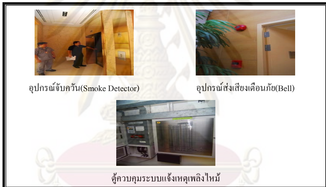
ภาพที่ 6.3.6 ระบบสัญญาณแจ้งเหตุเพลิงไหม้
