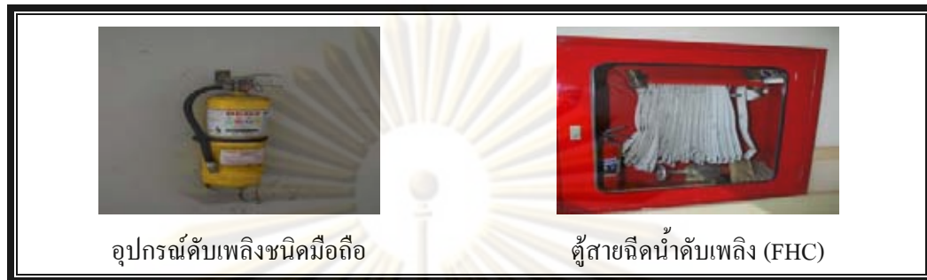
ภาพที่ 2.3.6 ระบบการติดตั้งอุปกรณ์ดับเพลิง
