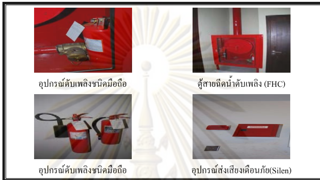
ภาพที่ 7.3.7 ระบบการติดตั้งอุปกรณ์ดับเพลิง
