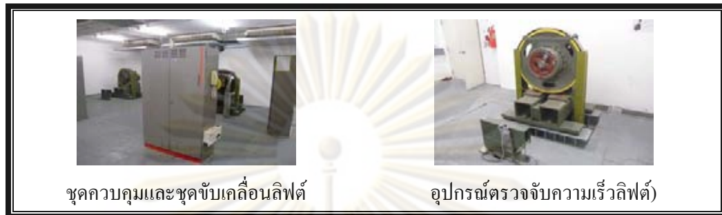
ภาพที่ 6.3.5 ระบบลิฟต์ดับเพลิง
