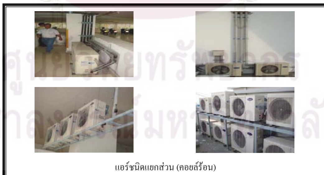
ภาพที่ 5.1.3 ระบบปรับอากาศ
