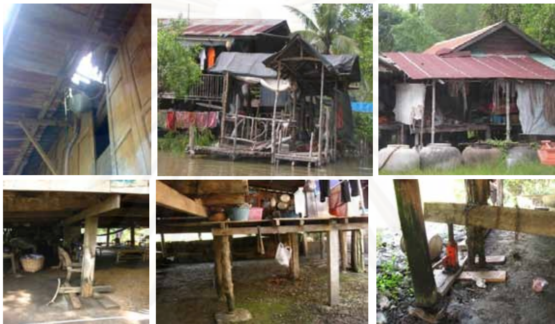
รูปที่ 3-6 : แสดงสภาพที่อยู่อาศัยที่ชำรุดและวิธีการซ่อมแซมที่พบในชุมชน
