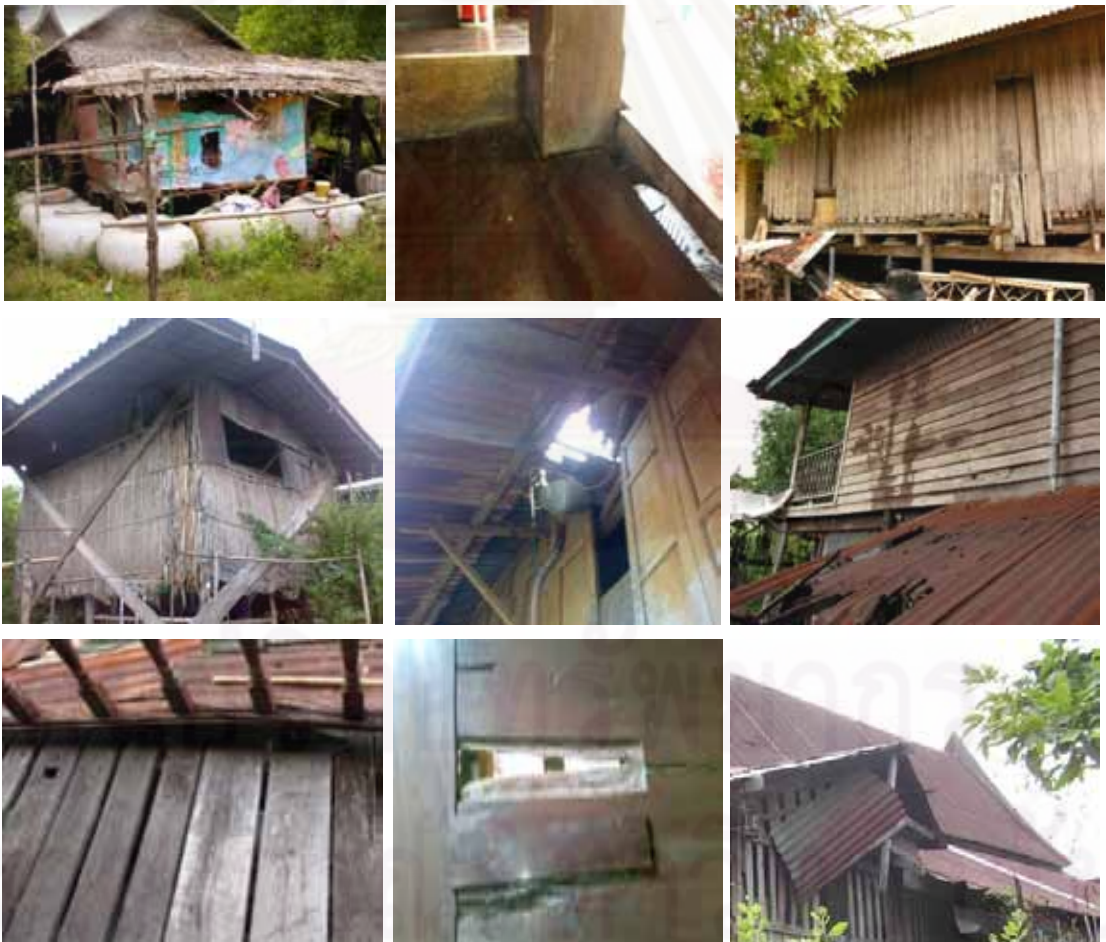
รูปที่ 5-1: แสดงลักษณะปัญหาด้านกายภาพของที่อยู่อาศัยในปัจจุบัน
