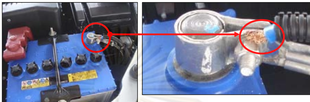
รูปที่ 5.14 รูปลักษณะปัญหาการติดตั้งสายไฟชั่วคราวแบบเตอรีไม่เรียบร้อย
