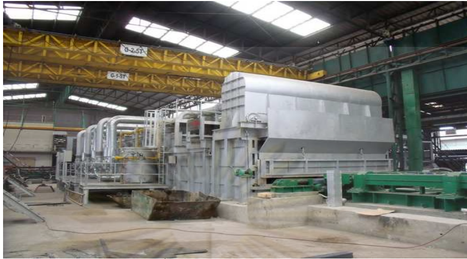
รูปที่ 4.2 เตา reheating furnace
