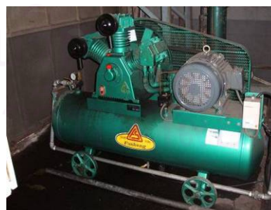
รูปที่ 3.5 เครื่อง compressor air
