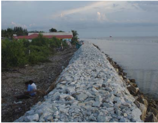
รูปที่ 2.2 เขื่อนกันคลื่นแบบหินทิ้งบริเวณชายฝั่งควรรู้ใช้กับชายฝั่งหน้าตัด
