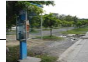
ตู้โทรศัพท์ องค์การโทรศัพท์ สภาเก่า ตำแหน่งใกล้ประตูทางเข้าหลักและที่จอดรถ บริเวณนี้ไม่มีไฟส่องสว่าง
