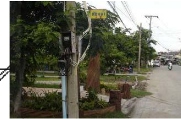
แนวเสาไฟและหม้อแปลงใกล้แนวทางเดินจากหลังวิหาร ไม่มีฝาปิดที่มิดชิด
