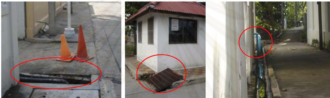
รูปที่ 4.44-4.46 (ซ้าย): และ (กลาง): ความไม่เรียบร้อยของระบบระบายน้ำ ท่อระบายน้ำถูกเปิดทิ้งไว้ (ขวา): การไม่แยกระบบระบายน้ำฝนออกจากระบบระบายน้ำทิ้ง
