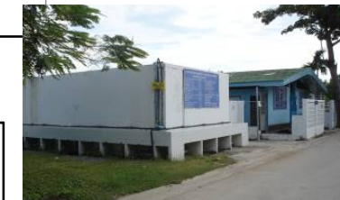
แทงก์น้ำประปา ใช้ในห้องน้ำและโรงครัว
