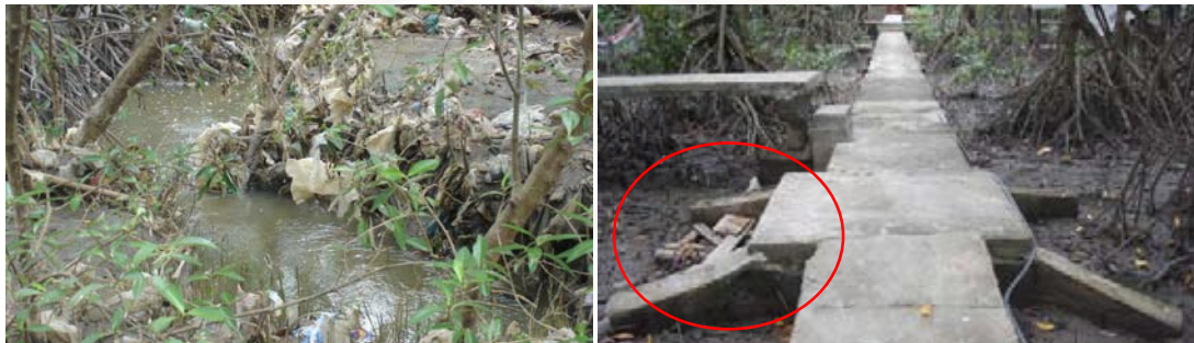
รูปที่ 4.50-4.51 (ซ้าย): แนวร่องน้ำขุดตื้นขึ้นจากการทับถมของขยะและกิ่งไม้ (ขวา): ท่อลอดใต้ทางเดินเพื่อให้ น้ำไหลผ่านถูกขยะและเศษไม้ปิดกั้นทางไหลของน้ำ
