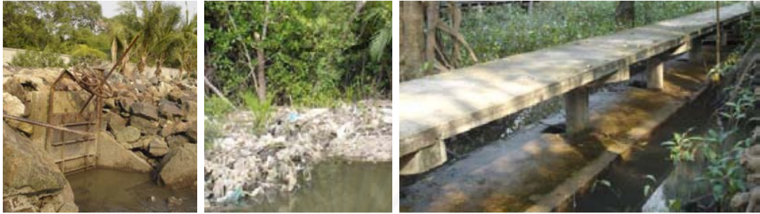
รูปที่ 4.47-4.49 (ซ้าย): ปัญหาแนวเขื่อนปิดกั้นทางไหลของน้ำทะเล (กลาง): ขยะที่น้ำทะเลพัดพาเข้ามาติดแนวหลังเขื่อน (ขวา): ทางเดินใหม่ก่อสร้างทับโดยไม่รู้ช่องทางเดินเก่าออกทำให้ปิดกั้นทางไหลของน้ำ
