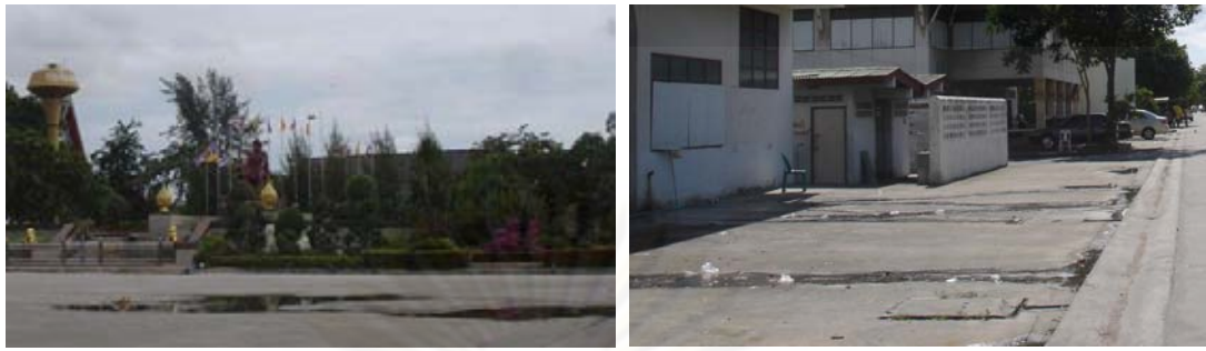
รูปที่ 4.42-4.43 (ซ้าย): การท่วมขังของน้ำในช่วงฤดูฝน บนลานคอนกรีตที่เชื่อมต่อระหว่างวิหารกับเจดีย์ (ขวา): ปัญหาความไม่เรียบร้อยของระบบระบายน้ำ น้ำเอ่อล้นก่อนไหลลงสู่ท่อ
