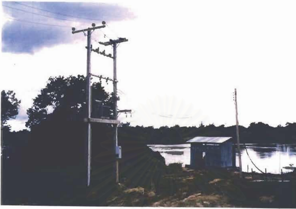
ภาพที่ 2.8 สายส่งไฟฟ้าแรงสูงเข้าไปยังตัวสถานี
