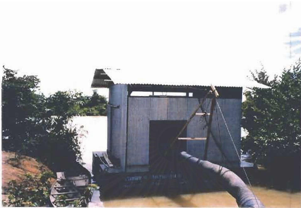
ภาพที่ 2.1 เครื่องสูบน้ำด้วยไฟฟ้าแบบหอยโข่งติดตั้งบนแพ
