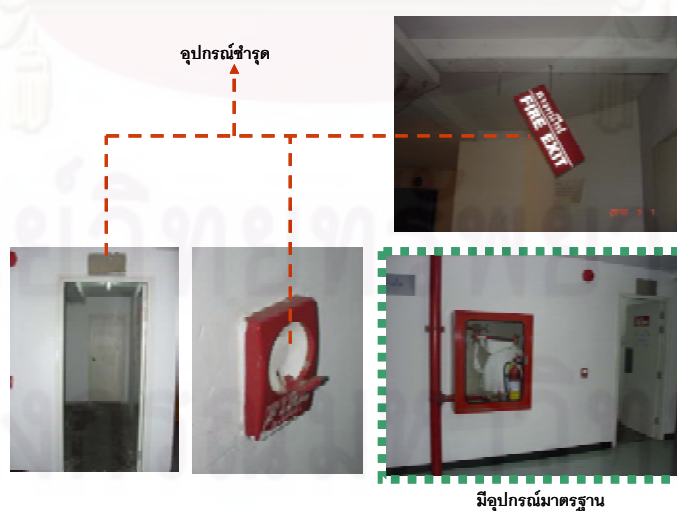
ภาพที่ 5.11 แสดงสภาพอุปกรณ์ป้องกันด้านอัคคีภัย
