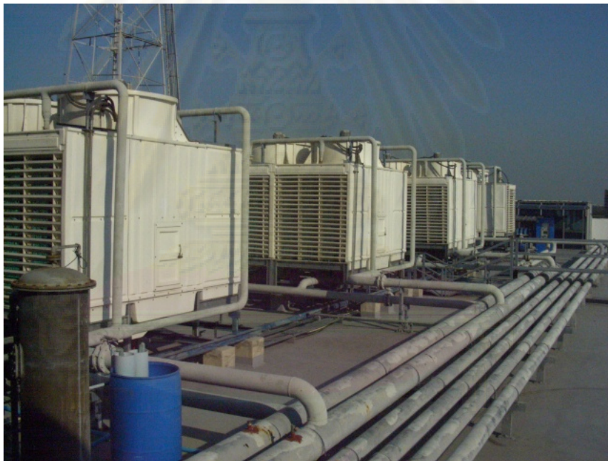
รูปที่ 4.9 หอผึ่งน้ำระบบปรับอากาศแบบชุด
