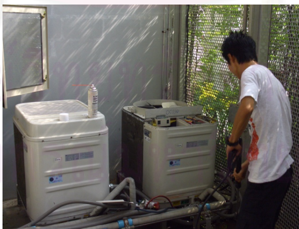
รูปที่ 4.11 การตรวจสอบครีบริบายความร้อนและทำความสะอาด
