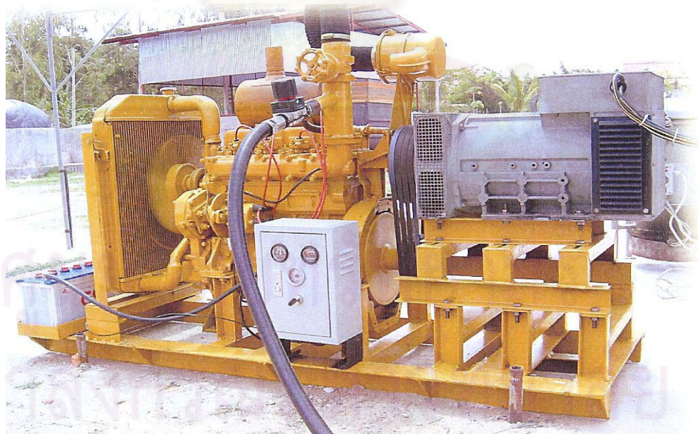
รูปที่ 4.5 เครื่องยนต์ดีเซล KOMATSU 4 สูบ 2,600 ซี.ซี + เครื่องกำเนิดไฟฟ้า ITALY Generator เจนเนอเรเตอร์ 43 kva
