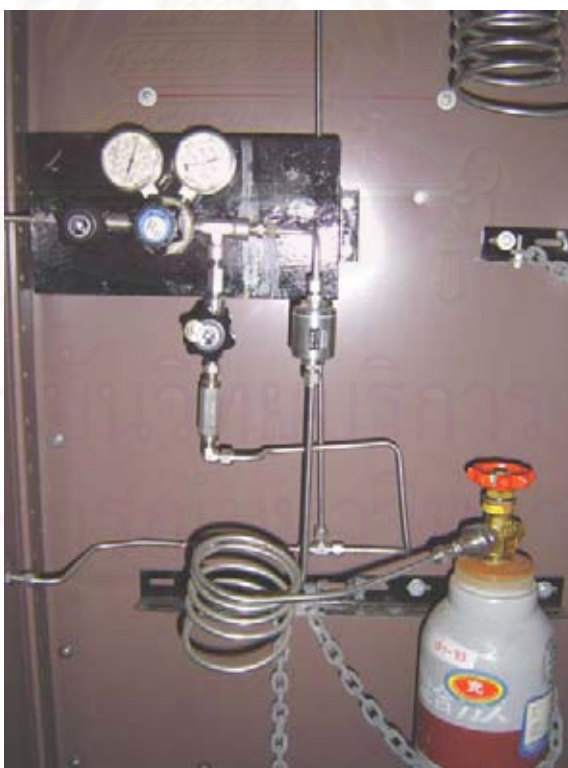
รูปที่ 3.9 ลักษณะการติดตั้งถังก๊าซและก๊าซเรกูเลเตอร์
