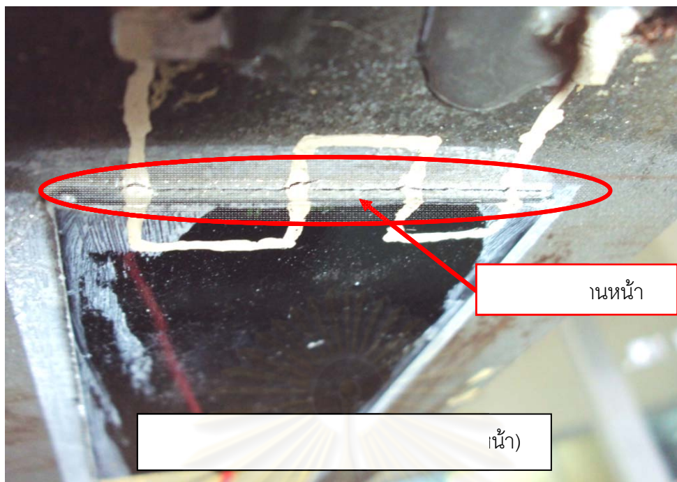
(ก) รอยร้าวที่ผิวสัมผัสระหว่างผิวเหล็กกับชั้นวัสดุประสานที่ด้านหน้าปลายแผ่นเสริม
