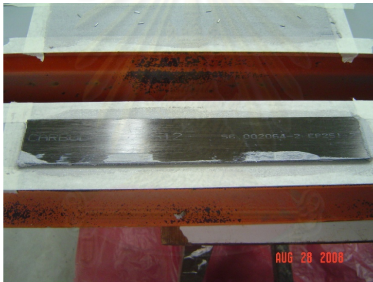
รูปที่ 4.4 ติดตั้งแผ่นพลาสติกเสริมเส้นใยคาร์บอนเข้ากับผิวคานเหล็ก
