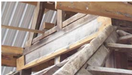
ภาพที่ 4.77 อะเสรับหลังคากันสาด
