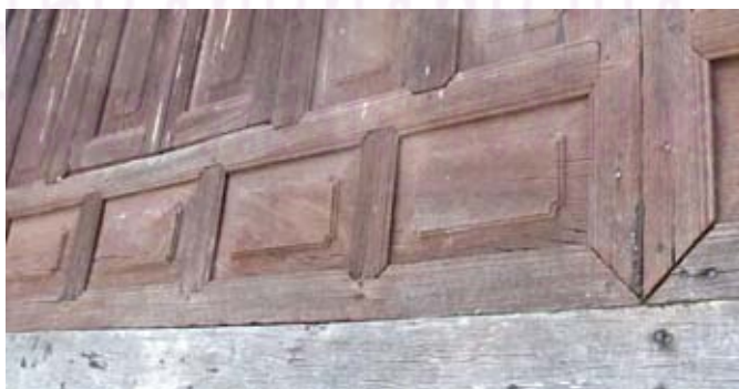
ภาพที่ 4.40 สภาพในปัจจุบัน การยึดแผงฝาผนังและพริ้งด้วยตะปู
