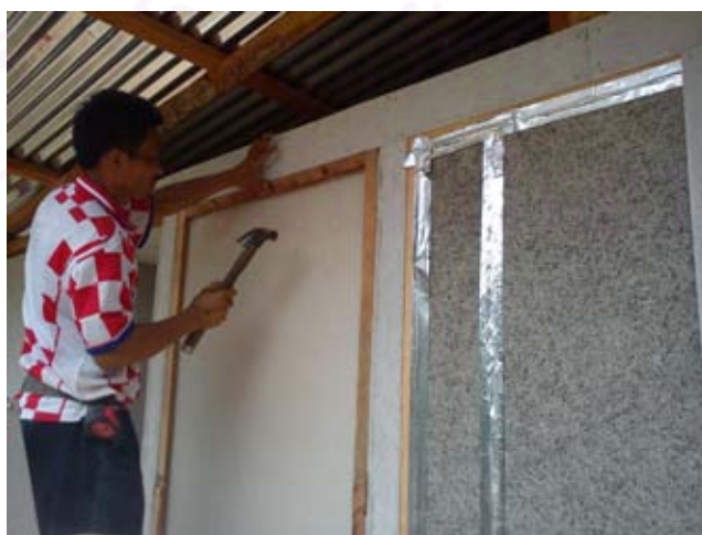
ภาพที่ 3.19 ภาพติดตั้งฉนวนความร้อนทางด้านทิศใต้
