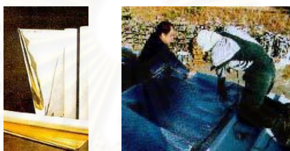
ภาพที่ 2.19 แสดงลักษณะของอลูมิเนียมฟอยล์และการติดตั้งบริเวณหลังคา
