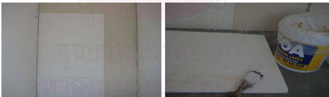
ภาพที่ 3.2 การติดฉนวนโฟมวัสดุอิฐมวลเบาปูนครึ่งแผ่น Brick 4" และอิฐมวลเบาปูนเต็มแผ่น Brick 8"
