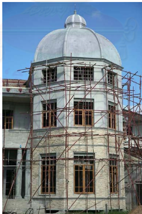
ภาพที่ 5.75 แสดงหลังคาโดมที่เสร็จสมบูรณ์
