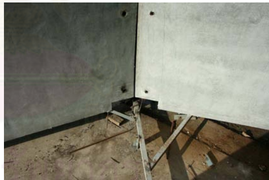
ภาพที่ 5.43 แสดงช่องเปิดสำหรับเชื่อมโครงสร้าง
