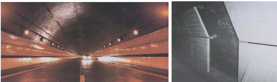
ภาพที่ 2.52 แสดงการใช้ GRC. ในงานผนังกันเสียงในอุโมง
