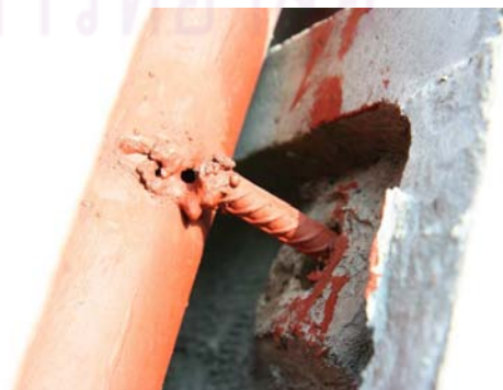
ภาพที่ 5.51 แสดงจุดเชื่อมต่อชิ้นงานกับโครงเหล็ก
