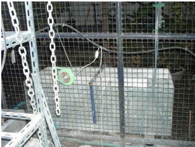
รูปที่ 3.11 ถังตกตะกอน
