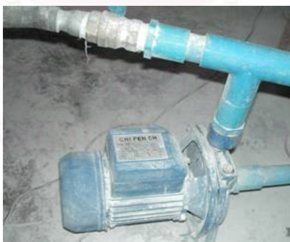
รูปที่ 3.12 ปั๊มน้ำ
