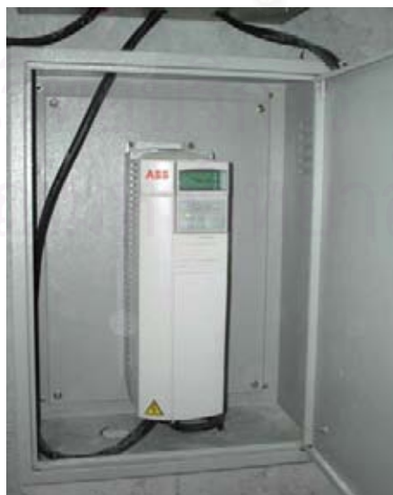
รูปที่ 3.7 เครื่องควบคุมความเร็วรอบ (Inverter)
