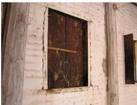
ภาพที่ 5-34 อิฐโบราณก้อนใหญ่ของผนังสิมวัดหมากมี และเสาไม้ภายในห้องสังฆกรรม ช่วยรับน้ำหนักโครงสร้างหลังคา
