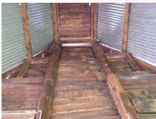
ภาพที่ 4-213 โครงสร้างหลังคาม้าตั้งใหม่ ผสมจันทัน
