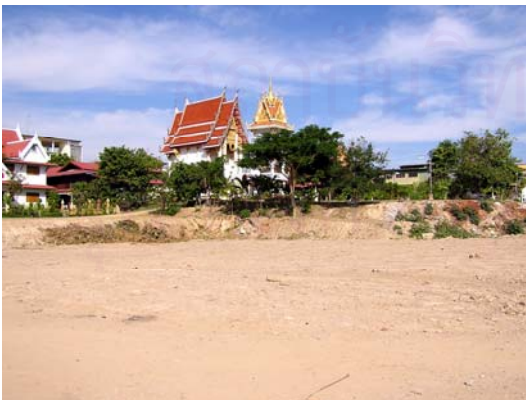
ภาพที่ 6-17 วัดเตรียมพื้นที่ถมดินด้านมุมวัดทิศตะวันออกเฉียงเหนือเพื่อทำโครงการสร้างอาคารพิพิธภัณฑ์ศูนย์ประชุมปฏิบัติธรรมและห้องสมุด ในอนาคต
