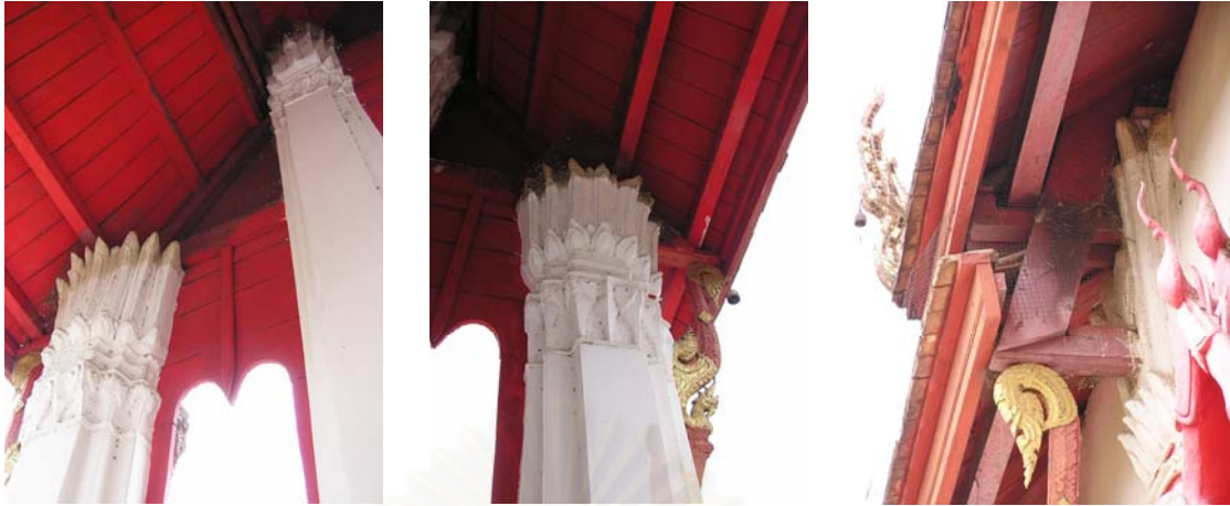
ภาพที่ 4-128 โครงสร้างหลังคา ภาพที่ 4-129 ใต้ชายคาของหลังคาต่บล่าง ภาพที่ 4-130 ไม้ยึดโครงหลังคาจั่ว จั่วสามเหลี่ยมบริเวณหน้าอุต ที่ยื่นยาวพาดเลยแนวเสาออกไป ชั้นบนและชั้นลดเพิ่มความแข็งแรง
