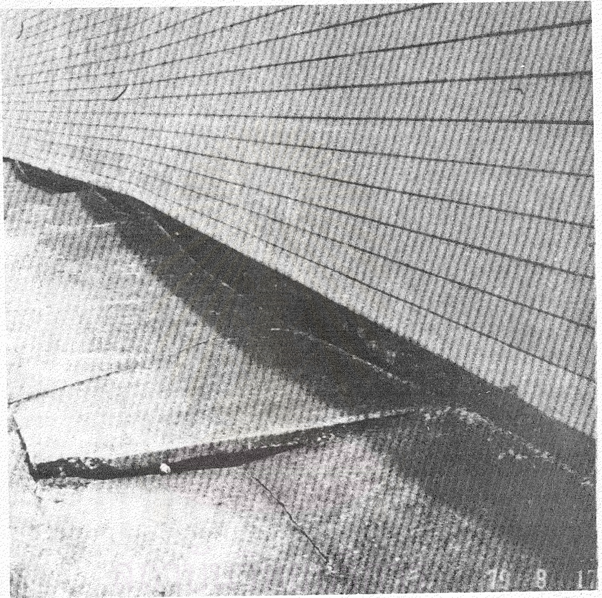
ทางเดินรอบอาคารทรุด เนื่องจากการทรุดของพื้นดิน
