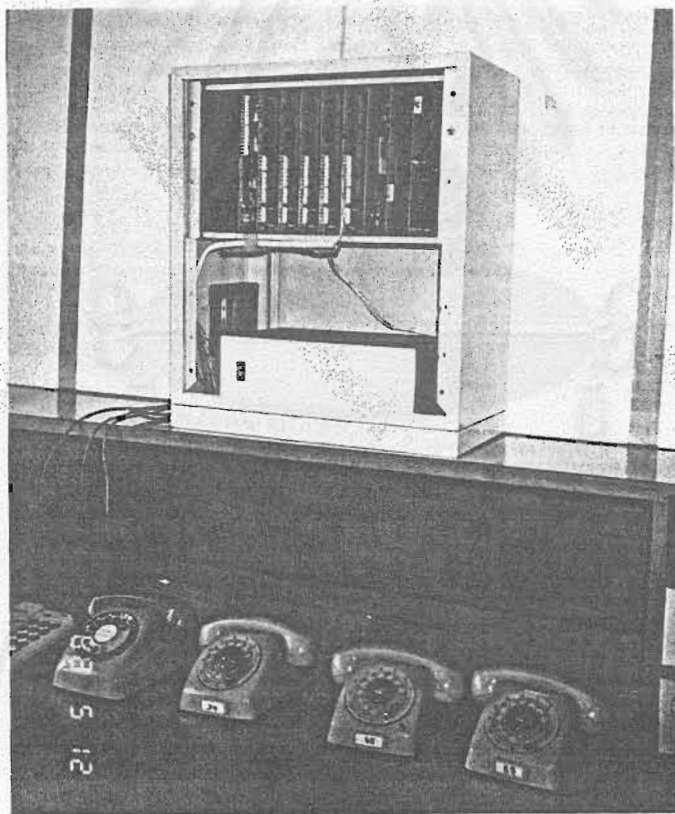
รูป 4.13 รูปถ่ายของตู้สาขาโทรศัพท์ที่ประกอบเสร็จ
