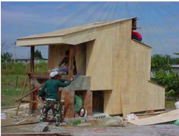
รูปที่ 3.13 อาคารทางทิศใต้ ขณะทำผนัง แกลบเสร็จ ก่อนมุงหลังคา
