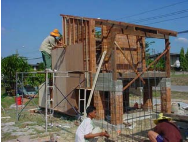
รูปที่ 3.12 การก่อสร้างอาคาร ส่วนผนัง ฉนวนกรูไม้อัด กรอกแกลบ
