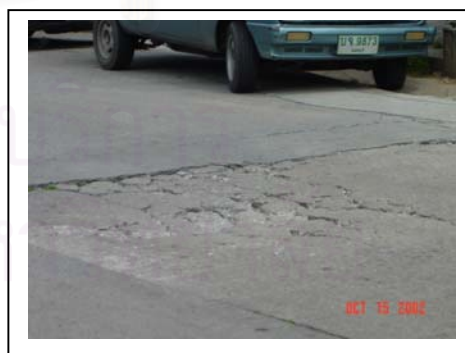
ภาพที่ 3.4 การขาดการซ่อมแซมถนนในโครงการฯ
