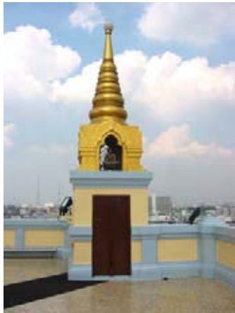
รูปที่ 4.1.7-16 ชุ่มยอดเจดีย์ เป็นส่วนที่ช่วยให้เกิดความต่อเนื่องระหว่างองค์ประกอบที่มีความสูงแตกต่างกันมาก โดยถ่ายความสูงจากยอดพระเจดีย์ลงมาที่ยอดชุ่มและต่อลงราวระเบียงลานประทักษิณจนถึงปลายหลังคาถันสาด
