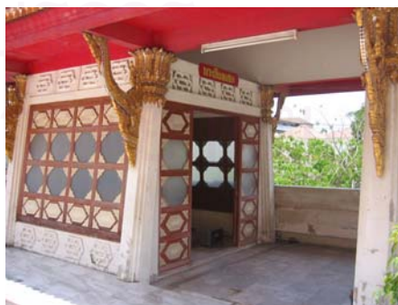
รูปที่ 4.2.2-35 ผนังของวิหาร พระเชียงแสน ทำเป็นลูกฟักแบบผนังไม้ ประตูทางเข้าเป็นบานเลื่อนไม้ลูกฟัก กระงกฝ้า
