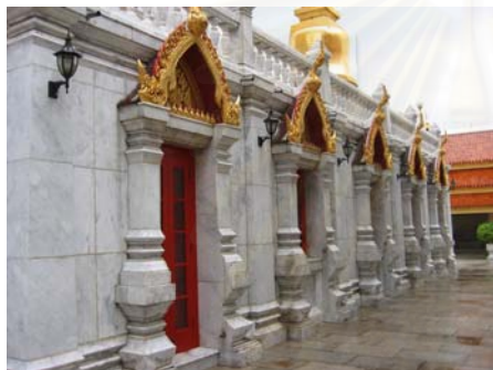
รูปที่ 4.2.7-10 องค์ประกอบและการตกแต่งในส่วนฐานชั้นที่ 1
