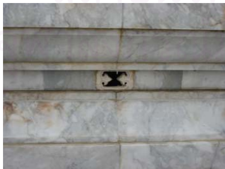
รูปที่ 4.2.7-30 ช่องระบายอากาศในส่วนฐานพระเจดีย์ ช่วย ระบายความชื้นที่อยู่ในส่วนโครงสร้าง
