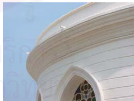
รูปที่ 4.1.9-22 องค์ประกอบส่วนผนัง บัวหงายและผนังกระเบื้อง
