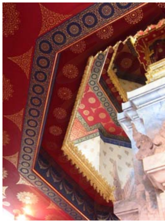
รูปที่ 4.2.8-77 การประดับตกแต่งในส่วนฝ้าเพดาน
