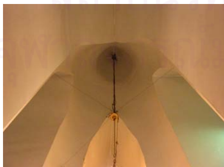
รูปที่ 4.1.7-26 ผนังรับน้ำหนัก เป็น Arch โค้งรับน้ำหนักองค์เจดีย์ทั้งหมด
