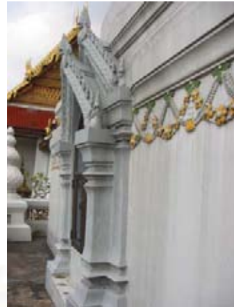
รูปที่ 4.1.6-23 ชุ่มจะระนำยื่นต่อออกมาจากส่วนฐานชั้นที่ 3 ลักษณะซอฟ้า รวยระกา และหางหงส์ เช่นเดียวกับชุ่มจะนำของฐานชั้นที่ 2
