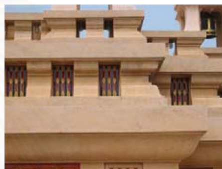
รูปที่ 4.2.5-11 ระหว่างหน้ากระดานบนและหน้ากระดานล่างของฐานชั้นที่ 2 เจาะเป็นช่องหน้าต่าง ส่วนชั้นที่ 3 เจาะเป็นช่องโปร่ง
