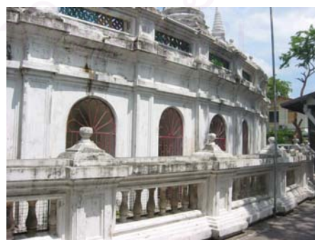
รูปที่ 4.1.3-29 ผนังของระเบียงคดเดินเส้นบัวได้บัวหงายอีกชั้นหนึ่ง
