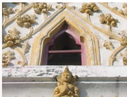
รูปที่ 4.1.5-47 ช่องระบายอากาศที่หน้าบันของพระปรางค์ประธาน
