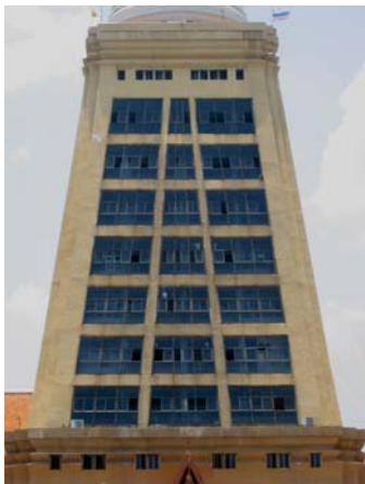
รูปที่ 4.2.2-56 ผนังกระจกด้านทิศเหนือมีช่องเปิดจำนวนมาก สามารถระบายอากาศได้ดี
