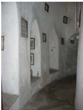
รูปที่ 4.1.6-34 พื้นที่ชั้นล่าง ส่วนมากเป็นพื้นที่ของ โครงสร้างผนังรับน้ำหนัก จากรูปแสดง Arch โค้งบริเวณผนังรอบนอก
