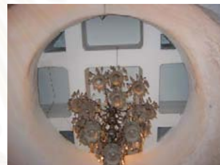
รูปที่ 4.1.6-5 เพดานบริเวณเหนือส่วนพระพุทธรูปจำลอง ติดคอมไฟ ซึ่งทำขึ้นภายหลัง
