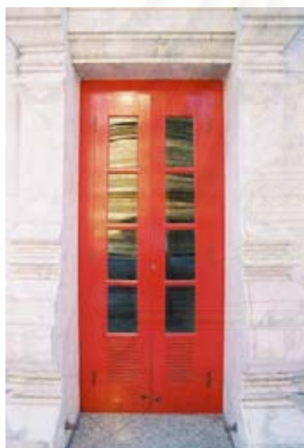
รูปที่ 4.2.7-28 บานประตูชั้นนอก ลูกฟักกระจกใสและ เกร็ดระบายอากาศ
