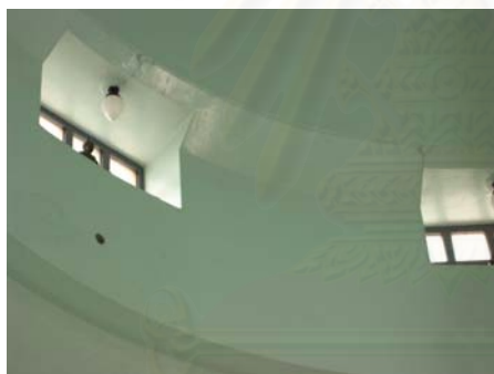
รูปที่ 4.2.1-29 หลอดไฟที่ติดอยู่ที่ช่องแสงในชั้นมาลัยเถา ให้แสงสว่างกับองค์ประกอบที่อยู่ในระดับบนในเวลากลางคืน
