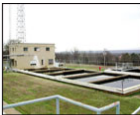
ภาพที่ 3.14 ระบบการบำบัดน้ำเสีย
