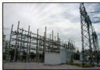
ภาพที่ 3.12 สถานีย่อยของการไฟฟ้า
