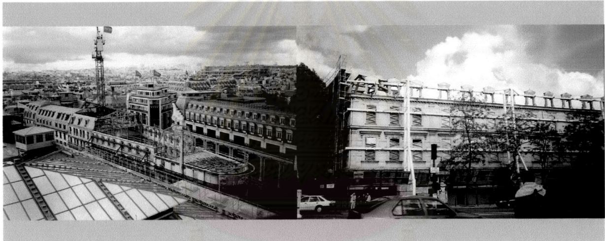
รูปที่ 3-47 ภาพแสดงมุมมองเทคนิคการก่อสร้างและการขยายวัสดุด้วยการสร้างครนยกของภายในอาคาร
