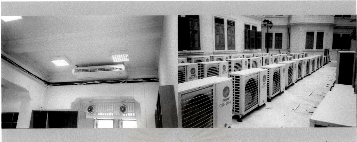
รูปที่ 3-50 ภาพแสดงการติดตั้งเครื่องจ่ายลมเย็น (fancoil unit) ที่ติดตั้งใต้ฝ้าเพดานภายในห้องนิทรรศการพิพิธภัณฑ์พระบาทสมเด็จพระปกเกล้าเจ้าอยู่หัว
