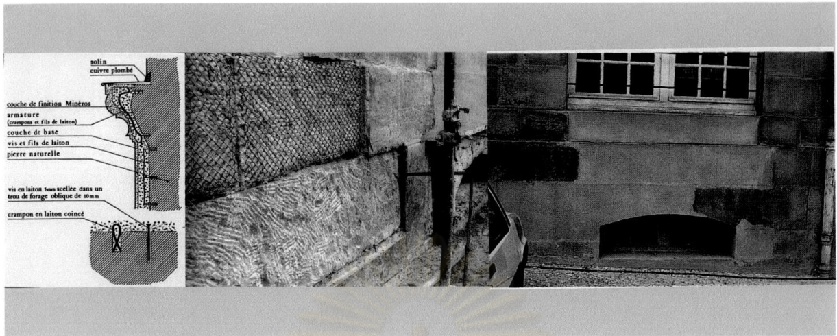
รูปที่ 3-40 ภาพแสดงการซ่อมแซมการเสื่อมสภาพของผนังด้วยการเสริมตะแกรงเหล็กในบริเวณที่มีความเสียหายแล้วฉาบปูนโดยแยกความแตกต่างระหว่างปูนฉาบใหม่กับผนังเดิม
