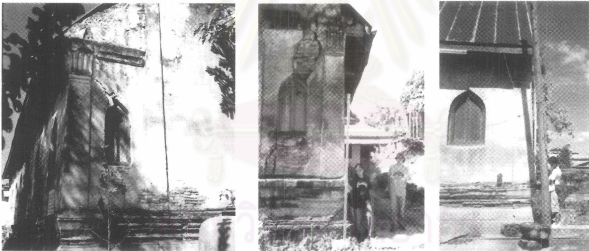
ภาพ 3-119 2 ภาพจากซ้าย รอยร้าวจนถึงแยกที่มุมอาคารเกิดที่ด้านสกัดทั้ง 4 มุมเป็นแนวเฉียง ขวาสุด ไม่ระดับแสดงให้เห็นการล้มสอปลเล็กน้อยของผนังอาคาร
