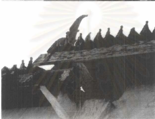
ภาพ 3-98 ภาพความเสียหายจากการไหลรั่วของน้ำบริเวณรอยต่อหลังคาทำให้มีไลเคนและคราบจุลินทรีย์เกิดขึ้น
