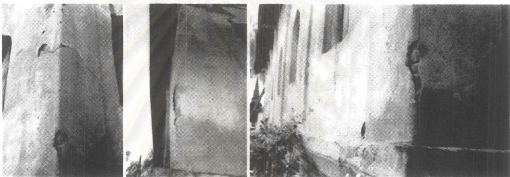
ภาพ 3-127 ภาพความเสียหายที่มุมอาคารจะเห็น รอยร้าวจากการเคลื่อนตัวร่วมกับการแยกตัวของ ปูนจากความชื้น
