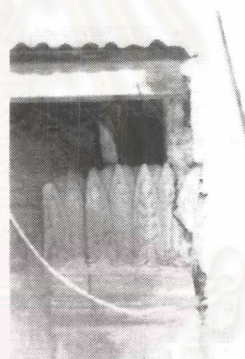
ภาพ 3-136 ซ้าย การนติดตั้งข้อในผนังจากด้านนอก โดยมีอิฐปิดหน้าไว้บ้าง เมื่อเกิดการเคลื่อนตัวจึงกะทะาะออกขวา โพรงในผนังจากการเสื่อมสภาพของข้อที่มุ่ม
