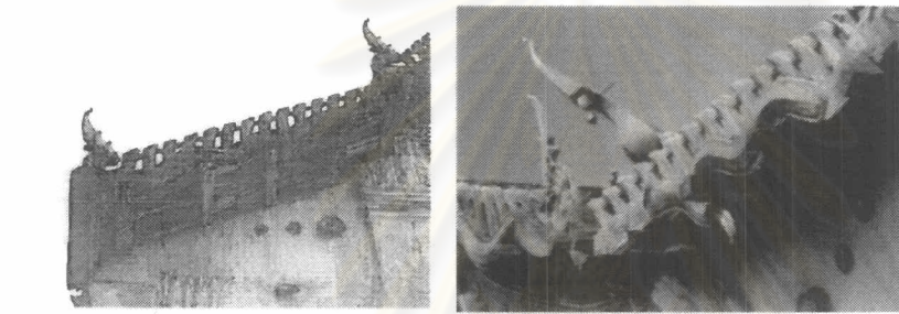
ภาพ 3-95 แสดงหลังคา ส่วนชั้นลด สังเกตการอุด ช่องว่างระหว่างโครงกับ ผนังด้วยอิฐ และ การผูก เป็ยของหัวไม้โครงสร้าง
