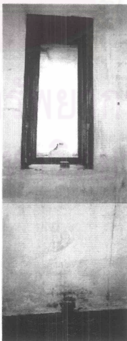
ภาพ 3-73 ซ้ำย ความเสียหายจากน้ำฝนที่สาดรั่วอยู่ในช่องหน้าต่าง และขวา ส่วนล่างของภาพคือช่องระบายน้ำจากการประกอบพิธีภายในโบสถ์ซึ่งปรากฏความชื้นอยู่รอบๆ
