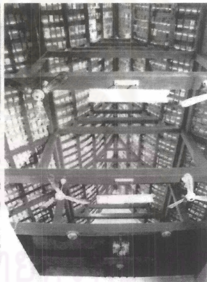
ภาพ 3-76 ภาพโครง หลังคาที่ได้รับการ ซ่อมแซมใหม่โดยยัง คงขึ้นไม้บางส่วนไว้
