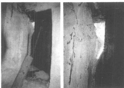
ภาพ 3-169 ซ้าย-ขวา ความเสียหายที่หน้าต่าง มุมตะวันออกเฉียงเหนือ จากรอยฉีกของผนังที่รุนแรง จนถึงให้ผนังเคลื่อน จากแนวทาบหลังและอิฐวง โค้งพังทลาย
