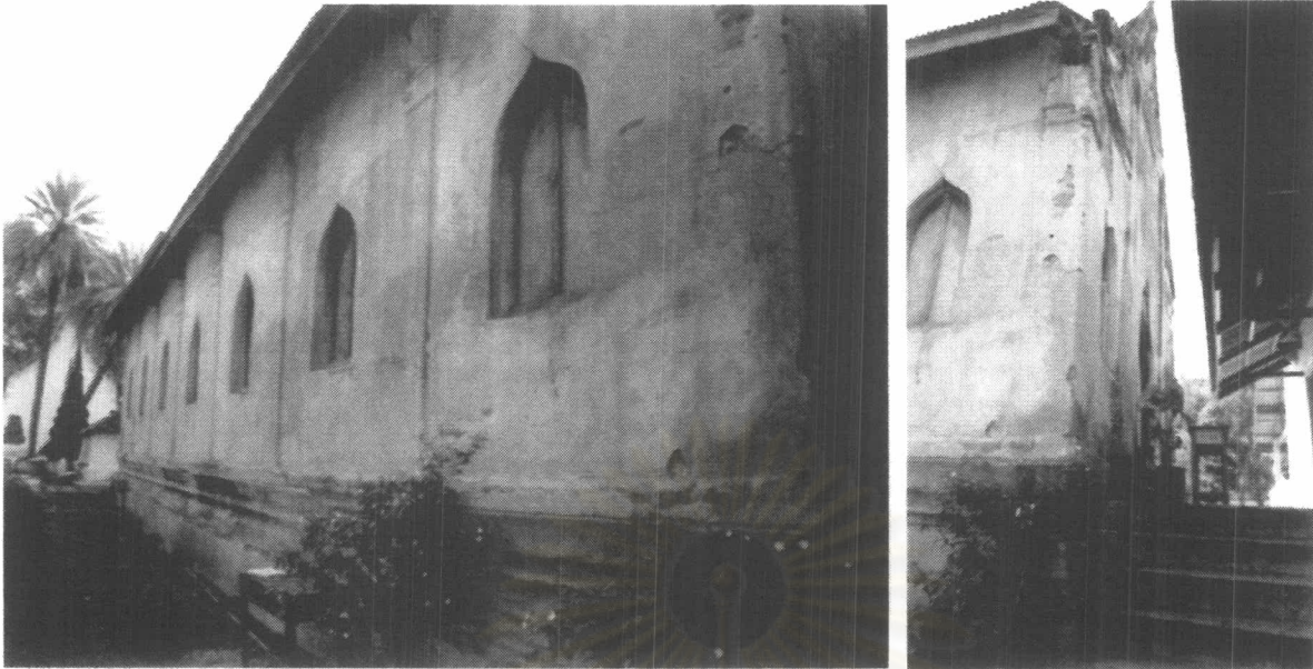
ภาพ 3-118 ซ้าย ผนังด้านเหนือมีความเสียหายน้อยที่สุดในสี่ด้าน ขวา มุมตะวันตกเฉียงเหนือ เห็นความเสียหายจากรอยแยกที่มุมซึ่งส่งผลให้เกิดรอยร้าว กะเทาะย่อยๆตามมาโดยเฉพาะบริเวณซอกและช่องเปิด
