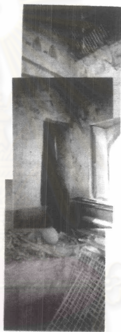
ภาพ 3-158 รอยแยกที่ มุมตะวันออกเฉียงใต้ ทะลุถึงภายในและวัง เข้าผนังด้านยาวที่ยอด บริเวณหน้าต่างสังเกต เห็นการทาสีเพื่อกิจบาง ประการ
