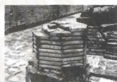
ภาพ 2-11 บน การเพิ่มความหนา ผนังด้วยการแปะอิฐ ซึ่ง ในกรณีนี้สันนิษฐานว่า อาจเป็นการซ่อมแซม ล่าง การทำอิฐรูปทรงพิเศษ เพื่อก่อเสาแปดเหลี่ยม
