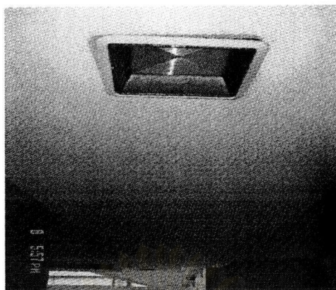
ภาพที่ 4-27 หลอดไฟทางเดินส่วนกลาง
