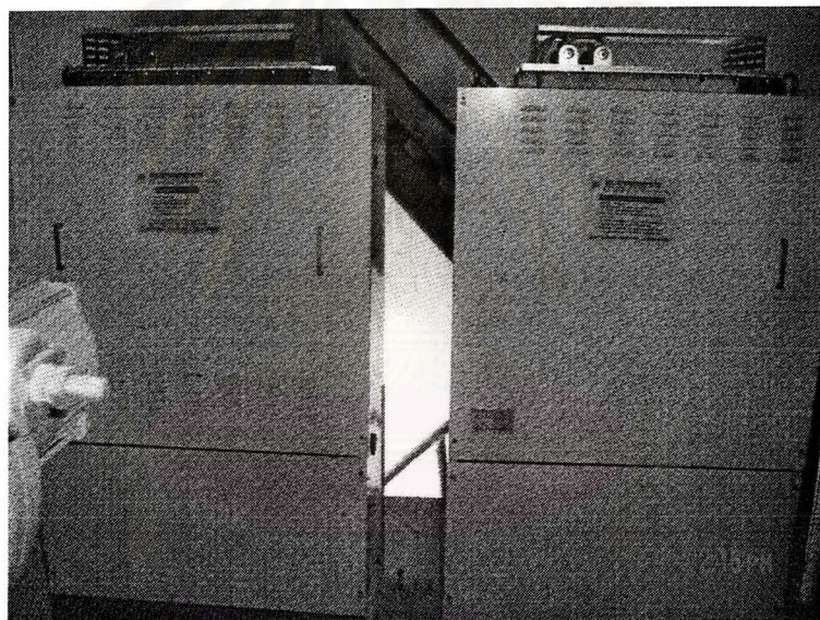
ภาพที่ 4-26 ตู้ควบคุมการทำงานของลิฟต์
