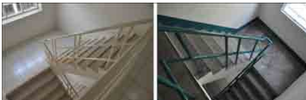
รูปที่ 4.16 แสดงบันไดและบันไดหนีไฟในโครงการ Lumpini Suite Sukhumvit 41
