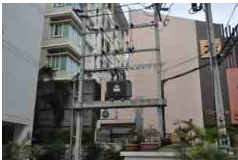
รูปที่ 4.51 แสดงหม้อแปลงไฟของโครงการ J-Visut Place
