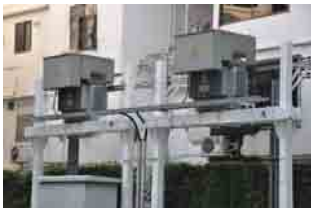
รูปที่ 4.26 แสดงหม้อแปลงไฟฟ้าในโครงการ Lumpini Suite Sukhumvit 41
