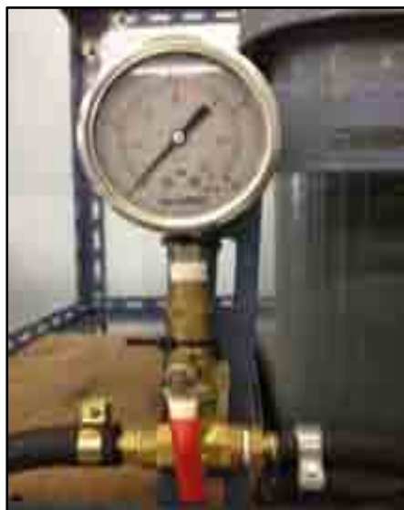
ภาพที่ ก-6 อุปกรณ์วัดแรงดัน
