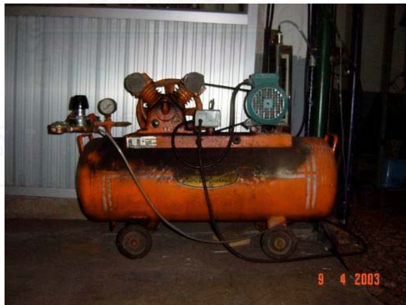
รูปที่ 3.5 เครื่องอัดอากาศ
